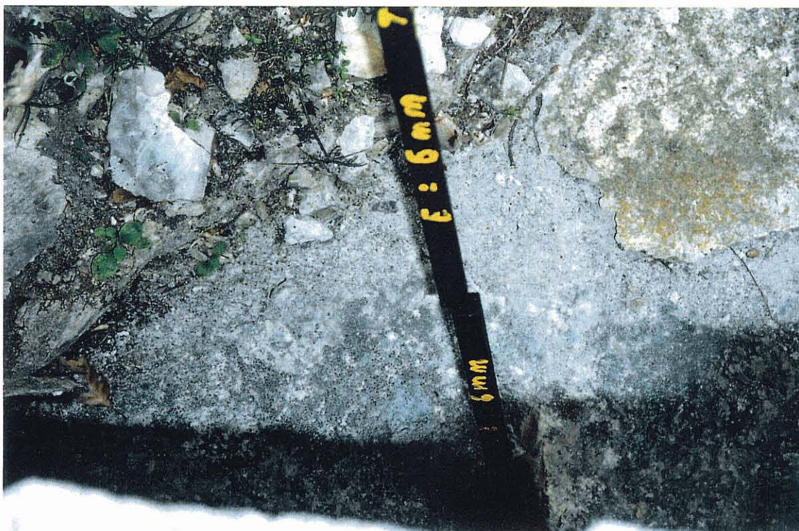
Témoïn n° 4 : noter l'écartement et le déplacement latéral
