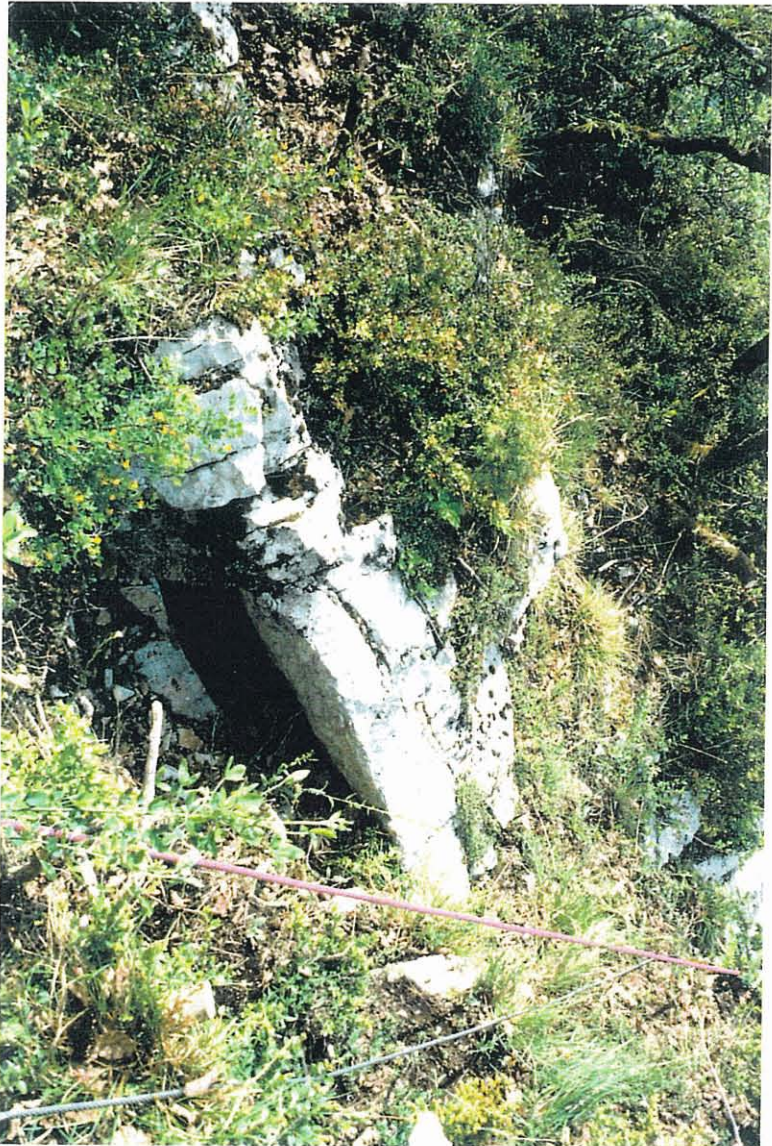
Fissure nouvelle près du témoin n° 4
