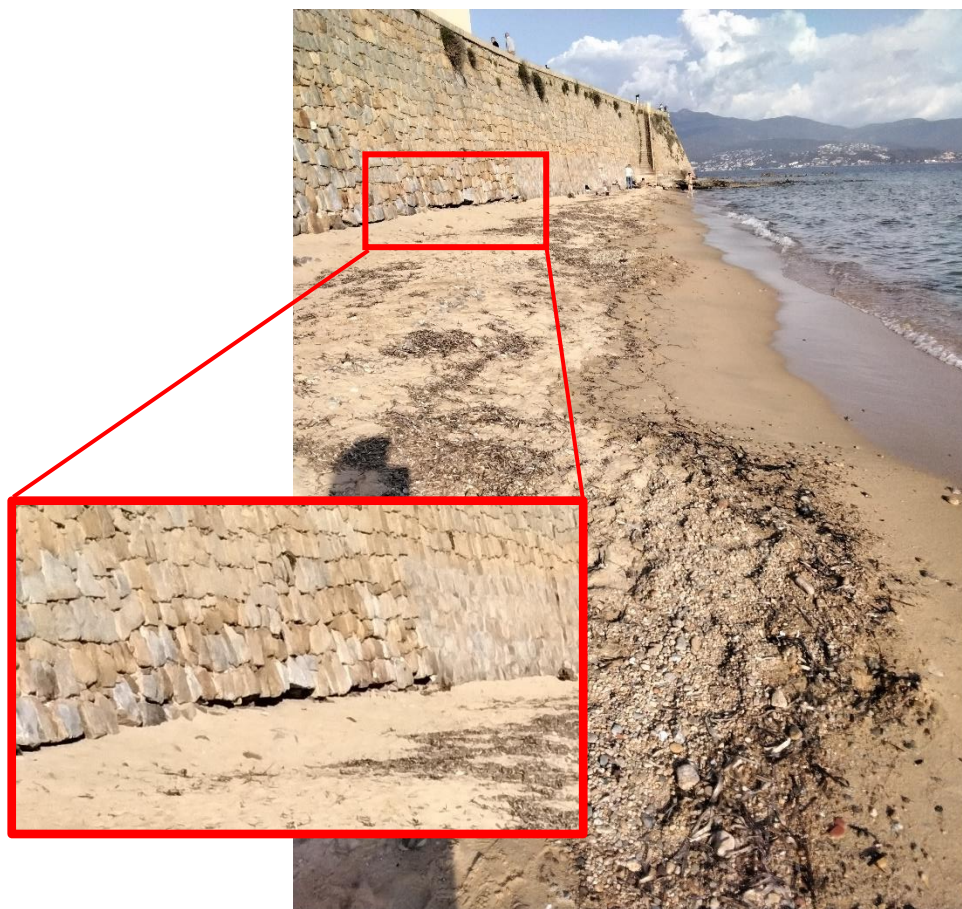
Figure 14 : Trait de côte bas (berme) et sous-cavage (cadre rouge) à Saint François le 09/05/2022.
