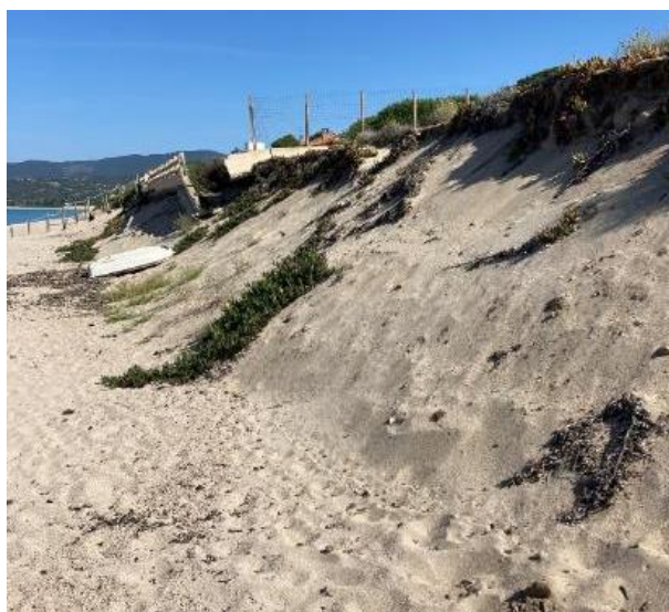
Figure 45 : Site de Taravo-Tenutelle, front dunaire marqué par une falaise d'érosion ancienne (adoucissement, éolisé) et ouvrages de protection côtière dégradés (BRGM, 17 juin 2022).
