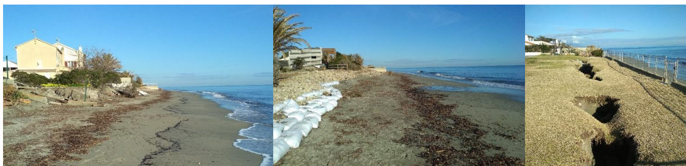
Figure 2 : Illustration des dégradations sur les infrastructures côtières de protection contre l'érosion marine (lotissement de Pineto à 2km environ au nord de l'embouchure, commune de Lucciana, février 2021).
