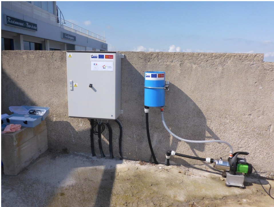
Illustration 11 : Station de mesure à terre, au sein de l'établissement Poissons du Soleil.
