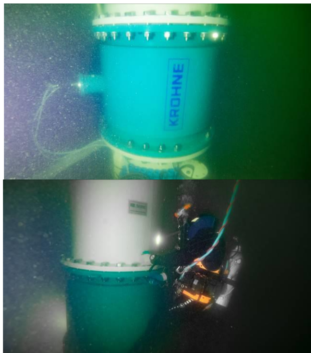
Illustration 10 : Installation du débitmètre et de son collecteur.
