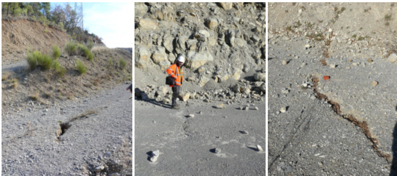
Illustration 23 – Fissures de traction, témoins des ajustements au sein de la masse en mouvement
