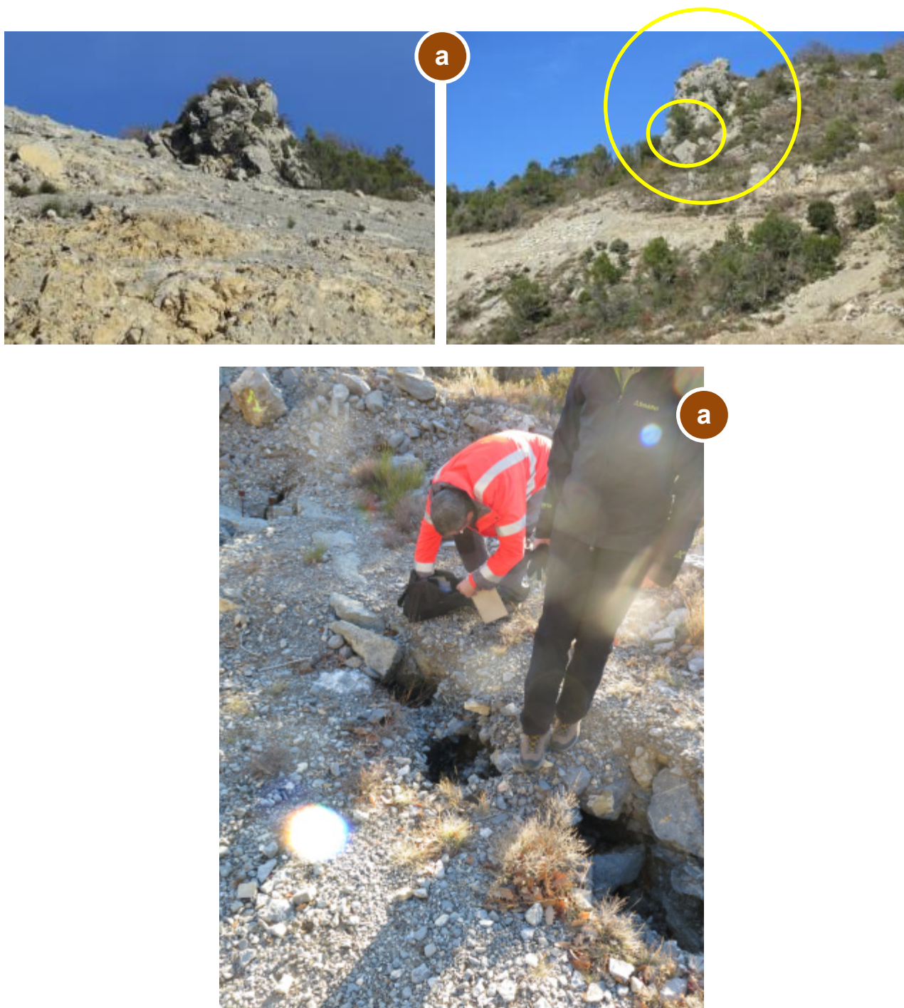
Illustration 17 – Vues point 3'. Eperon rocheux et fissure de traction en amont immédiat de l'éperon (2)
