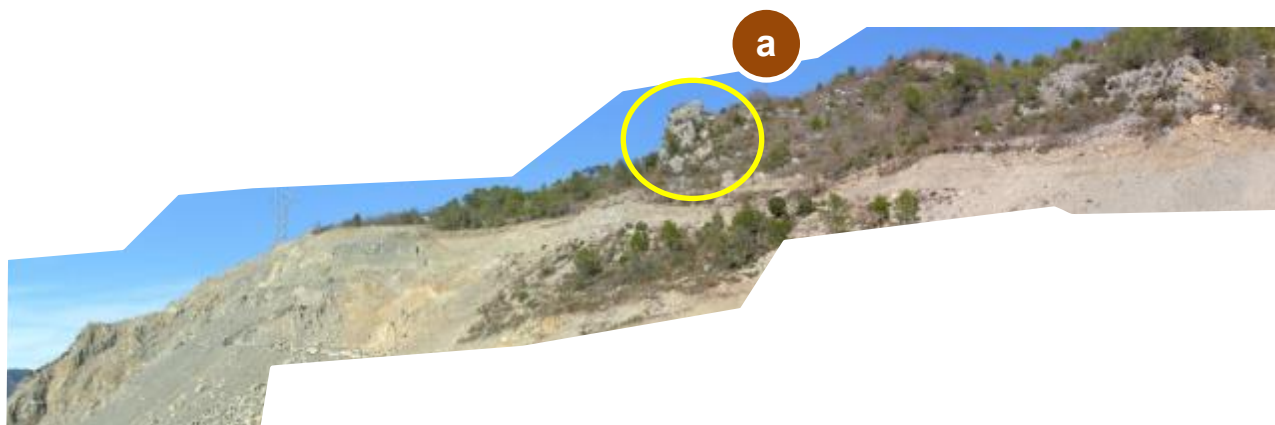
Illustration 16 – Vues point 3'. Eperon rocheux et fissure de traction en amont immédiat de l'éperon (1)
