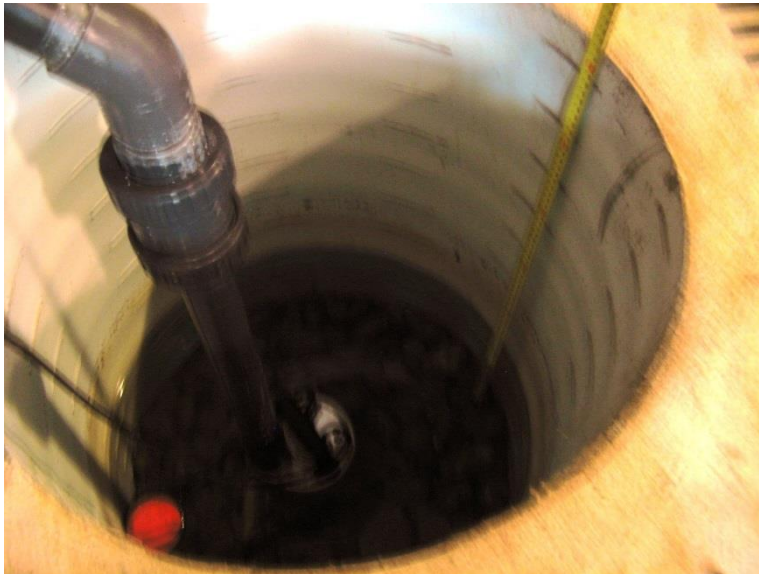
Illustration 10 – puits équipé d'une pompe dans la cave de M. Pastor (photographies BRGM 28/05/15)
