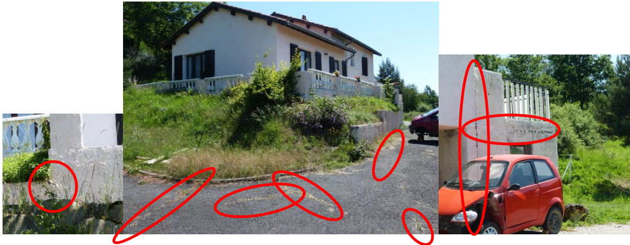
Illustration 22 : dommages constatés sur les sols goudronnés, murets et façades de la maison de la parcelle A1082 imputés au phénomène de retrait/gonflement
