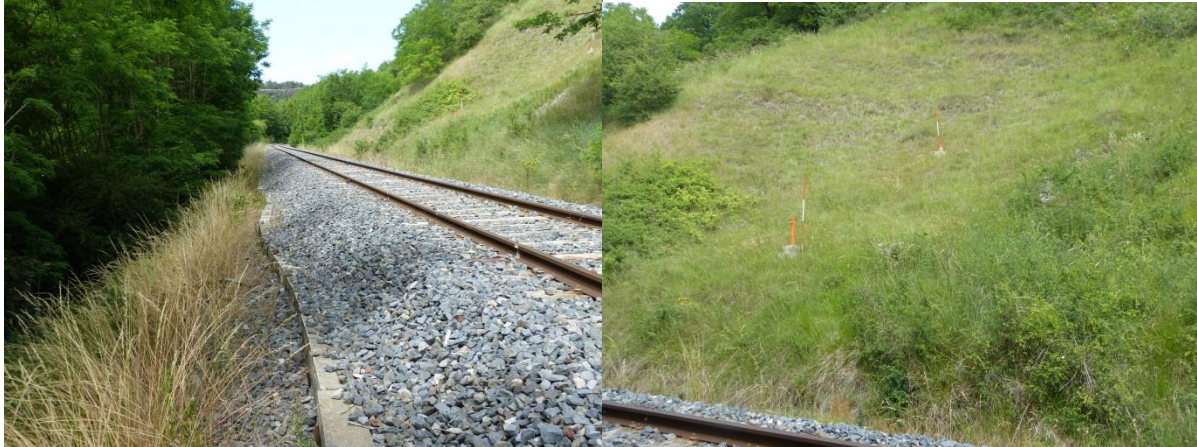
Illustration 37 : versant marneux à potentiel d'instabilité marquée en amont de la voie ferrée
