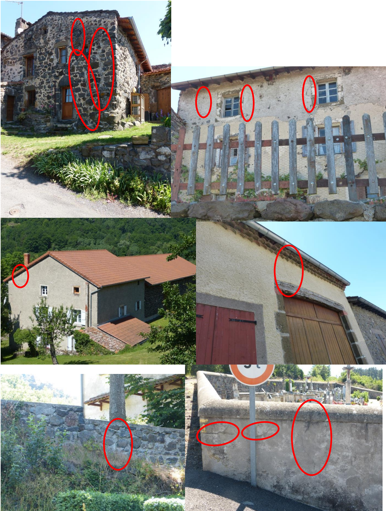
Illustration 21 : dommages constatés sur les murs et façades du centre bourg imputés a priori au phénomène de retrait/gonflement
