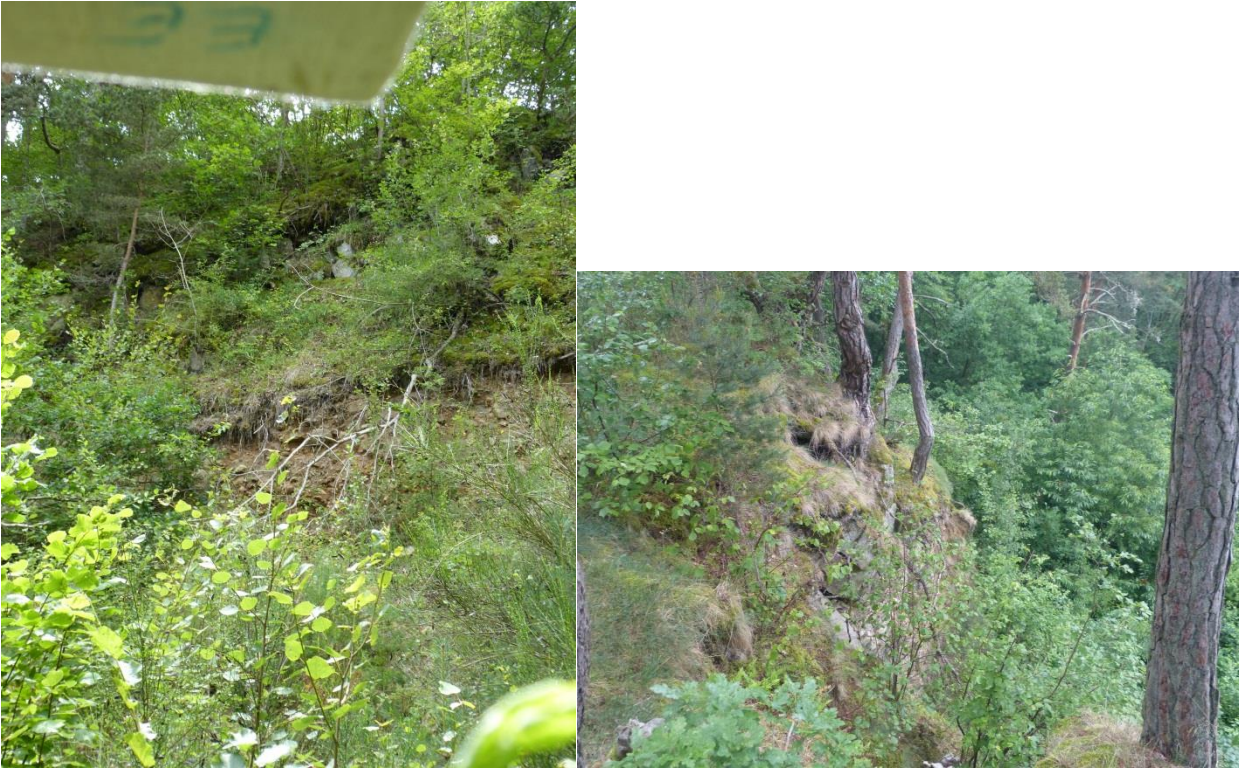
Illustration 67 : front verticalisé vue de l'aval depuis le glissement plan de Borne-Vidal et en tête (en aval du chemin carrossable)
