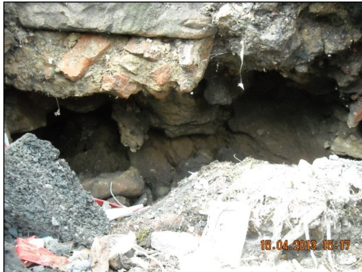
Figure 9 : Vue au fond de l'effondrement, sous le coin Est de la maison
