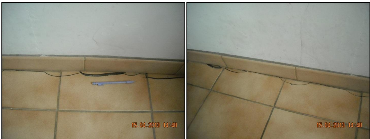
Figure 13 : Fissures du carrelage de la salle
