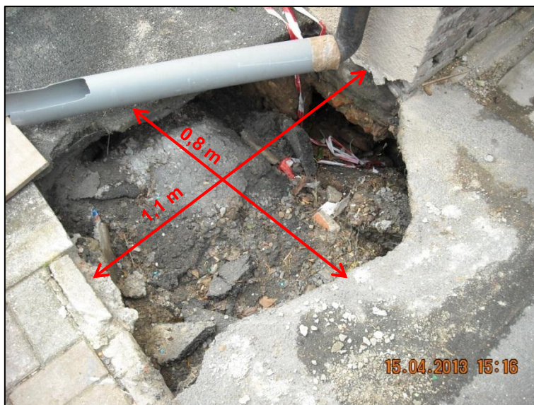
Figure 5 : Dimensions de l'effondrement de terrain
