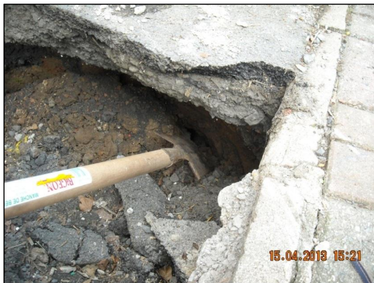
Figure 11 : Prolongement de l'effondrement en direction du nord-est
