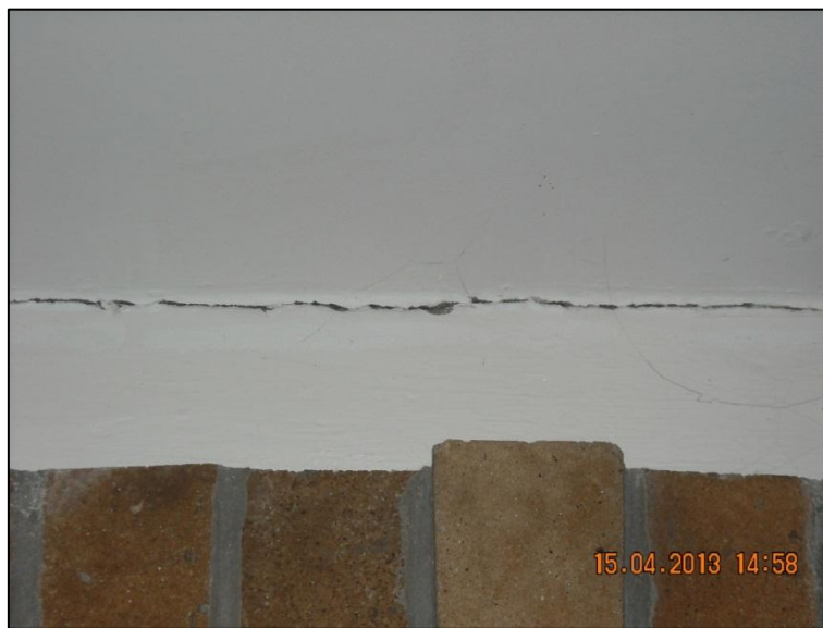
Figure 15 : Zoom sur la fissure de la figure précédente
