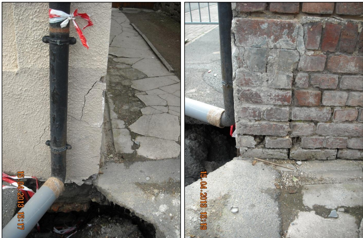
Figure 8 : Zoom sur le coin Est de la maison au dessus de l'effondrement
