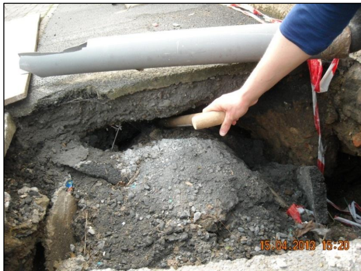
Figure 10 : Prolongement de l'effondrement en direction du sud-ouest
