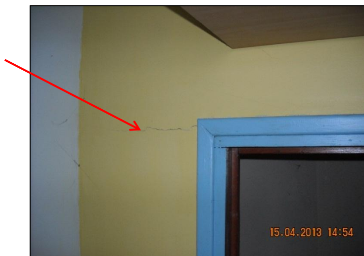
Figure 18 : Fissure au dessus de la porte de la chambre n°1
