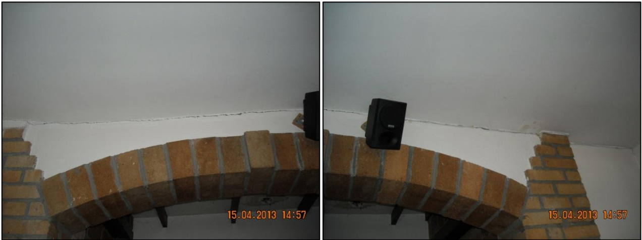
Figure 14 : Fissures à la jointure entre le plafond et le passage voûté
