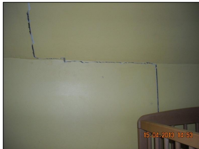
Figure 17 : Fissures sur le mur sud de la chambre n°1
