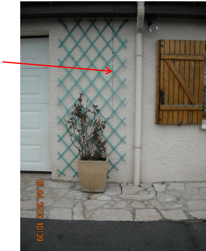
Figure 13 : Fissure verticale entre le garage et la maison en façade sud-est
