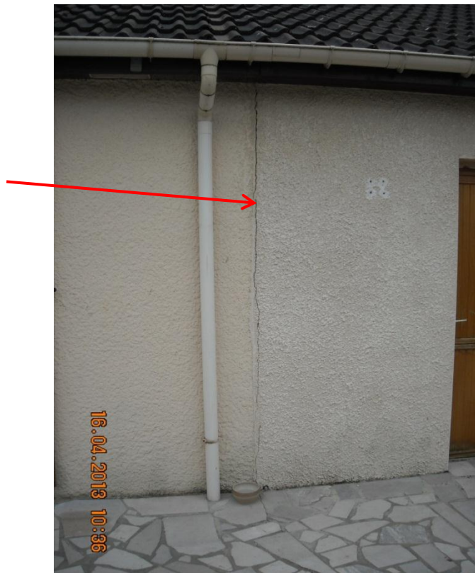
Figure 12 : Fissure verticale à la jointure entre la maison et le garage
