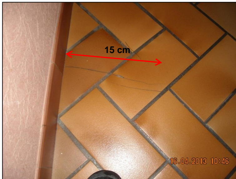
Figure 17 : Petites fissures sur le sol du couloir
