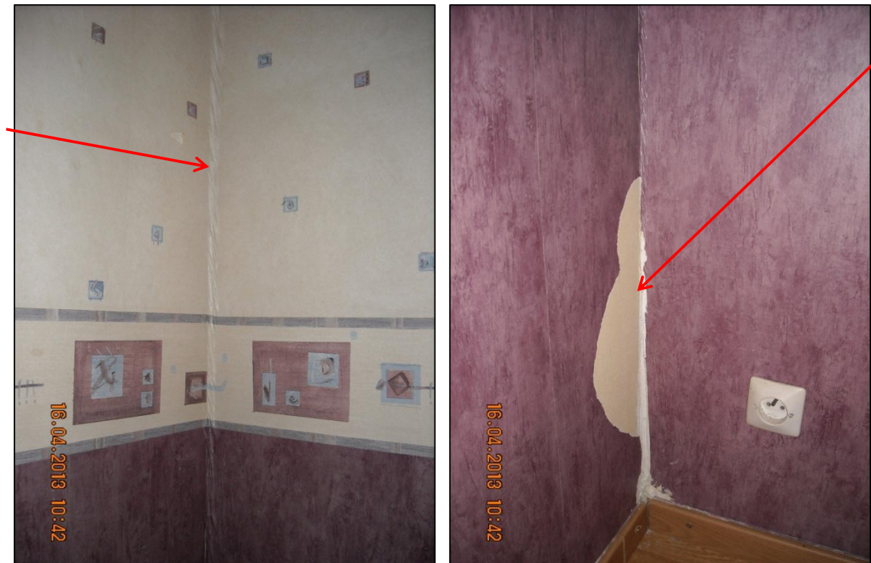
Figure 15 : Fissure verticale et tapisserie déformée au coin nord
