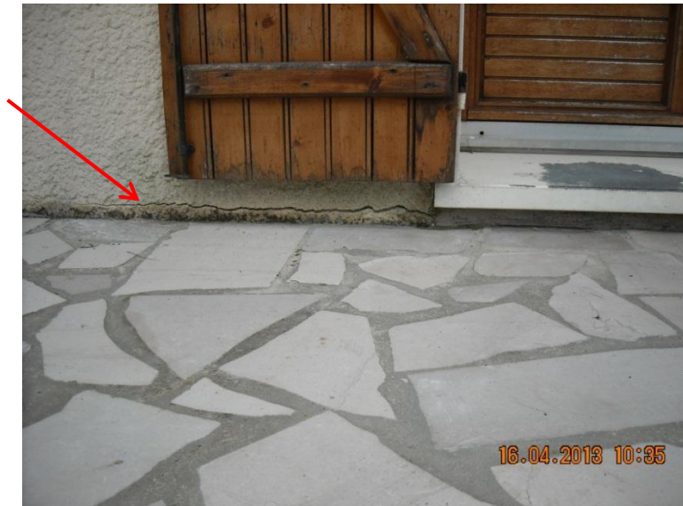
Figure 11 : Fissure horizontale au pied de la porte fenêtre située le plus au nord
