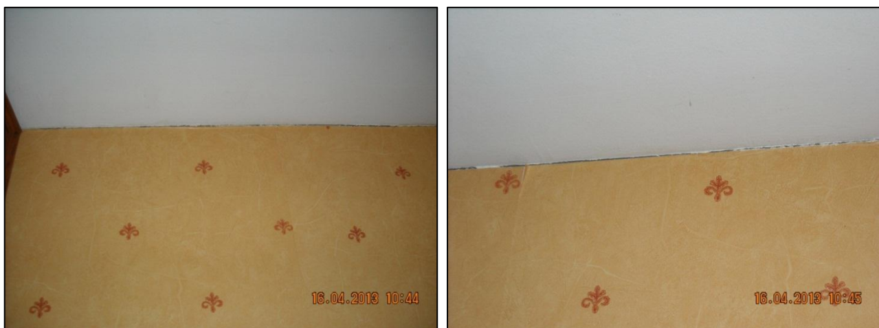
Figure 16 : Fissure horizontale au plafond de la chambre située à l'est
