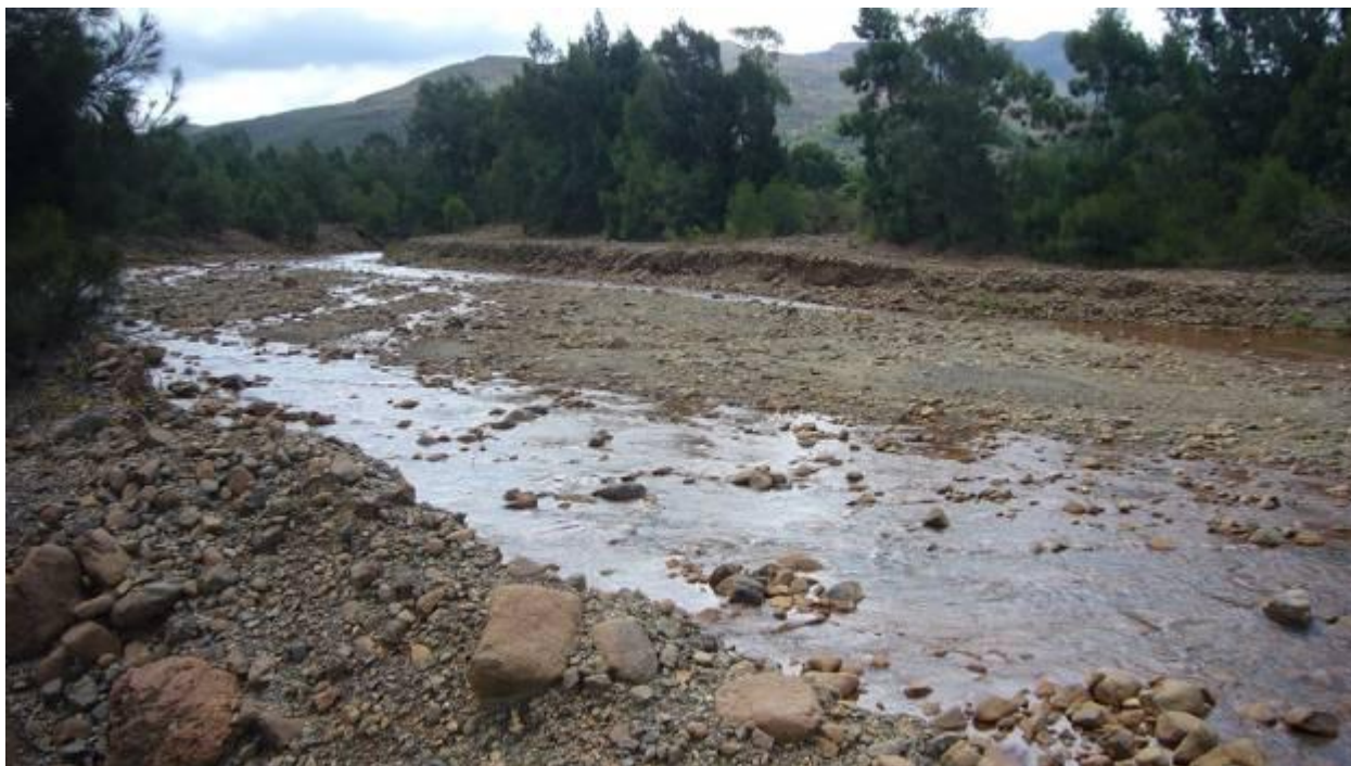
Illustration 21 : Travaux de recalibrage de l'aval du cours de la Wa Pukeme suite à son sur-engravement (Pt162).
