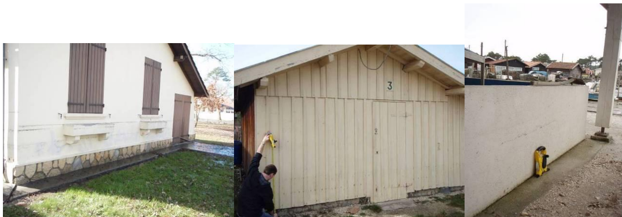
Figure 2 : Hauteurs d'eau mesurés à partir des laisses de mer et des traces sur les murs (Xynthia 28/02/2010).
