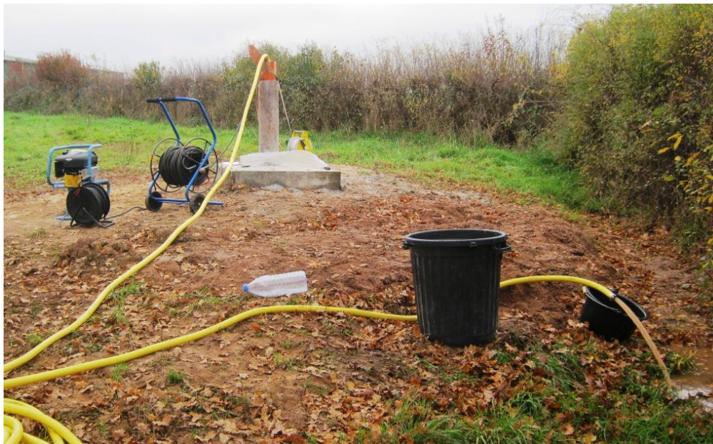
Figure 9 : photo du dispositif de pompage
