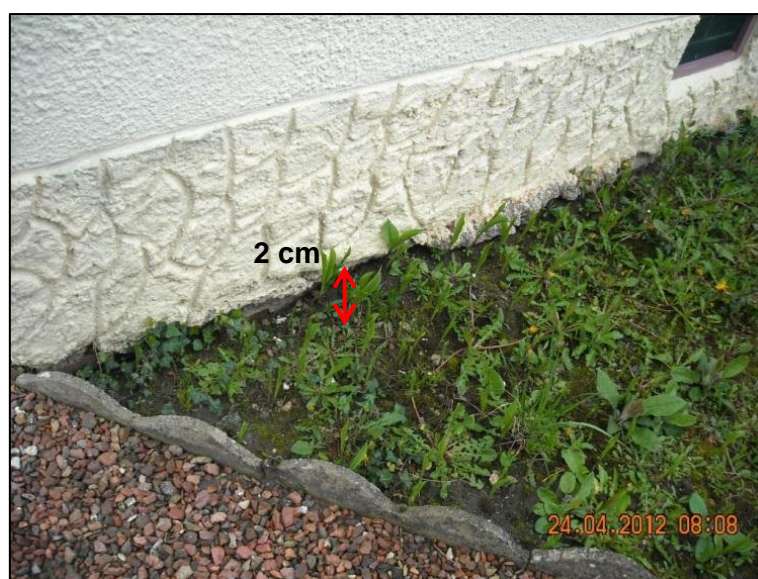
Figure 9 : Affaissement du terrain en bordure de la maison, façade nord-ouest
