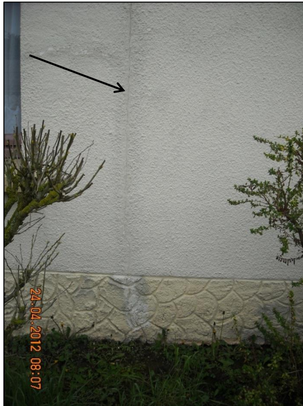
Figure 8 : Fissure verticale à l'arrière de la maison
