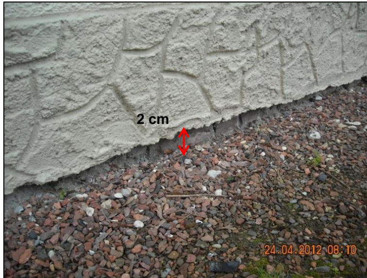
Figure 10 : Affaissement du terrain en bordure de la maison, façade nord
