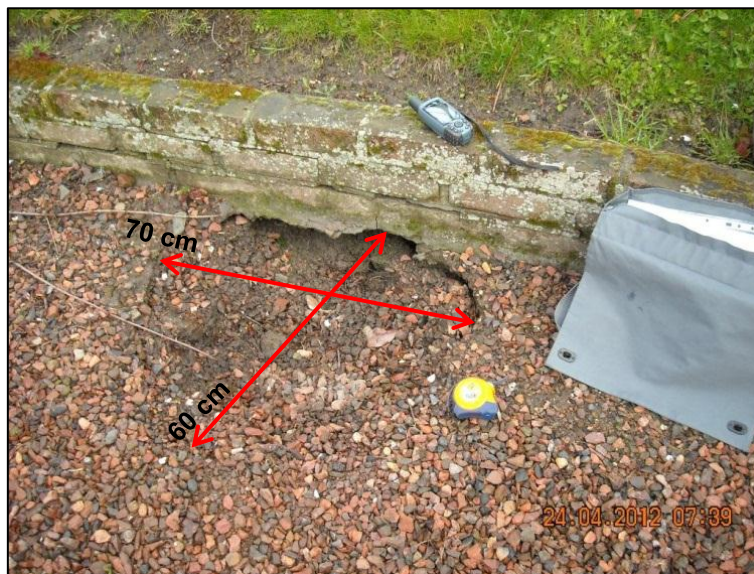
Figure 6 : Vue générale de l'affaissement de terrain
