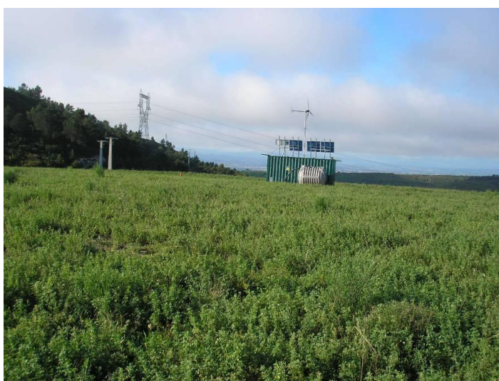
Illustration 10 - Station autonome de pompage de Montredon – Commune de Salsigne (11).
