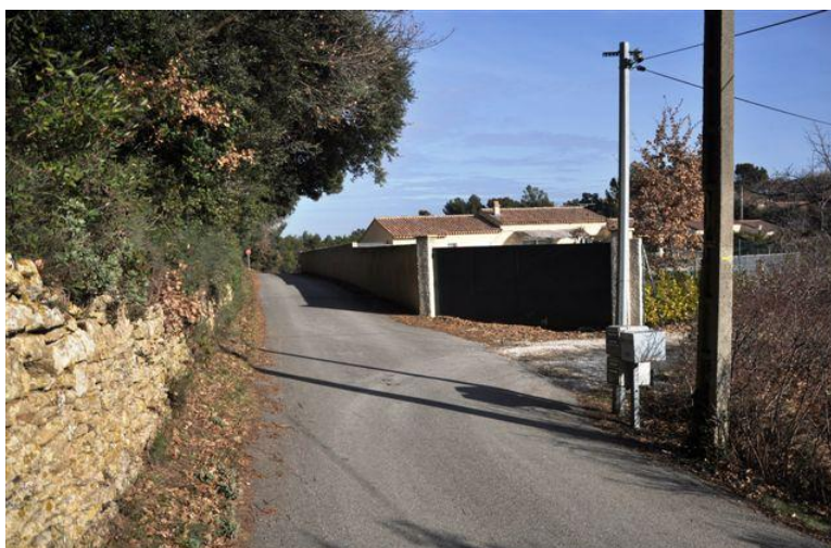
Illustration 21 - Immeuble et Chemin de l'Aire sous-cavé - Commune de Gaujac (30).
