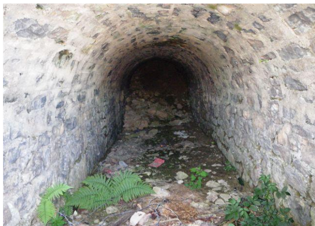
Illustration 18 - Entrée de galerie à traiter – Commune du Bleymard (48).
