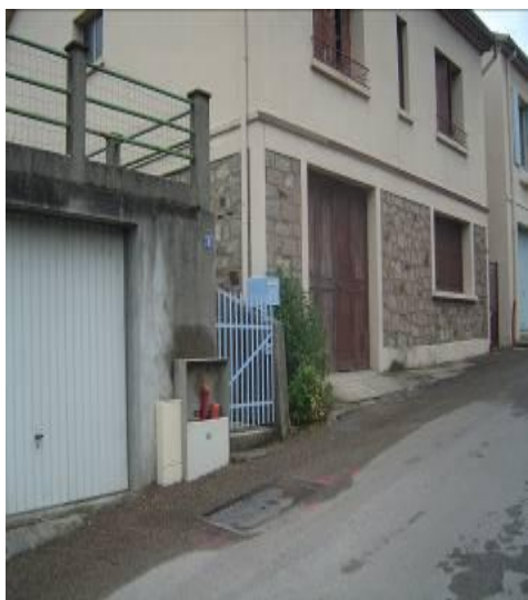
Illustration 22 - Situation du fontis - Commune de Branoux-les-Taillades (30).
