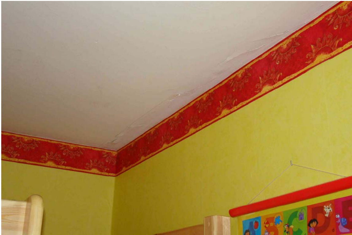
Photo 5 : Fissure au plafond d'une chambre située contre le mur SE
