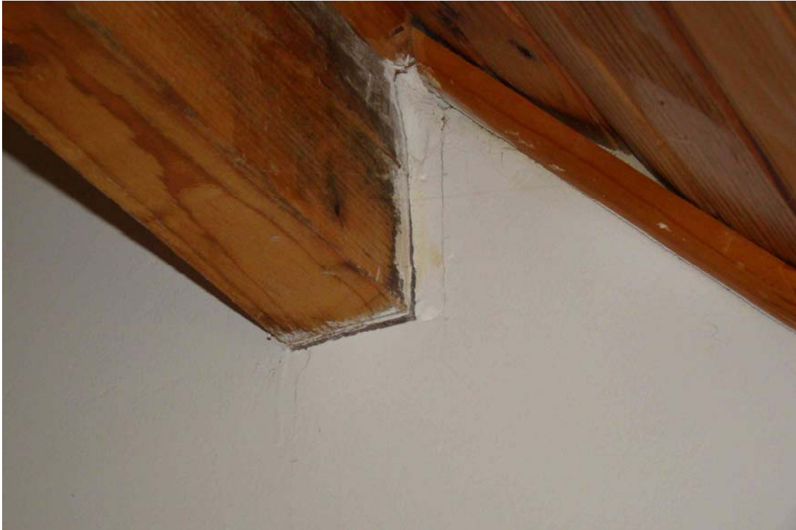
Photo 7 : Fissuration au niveau de la jonction des poutres et des cloisons (partie « garage »)
