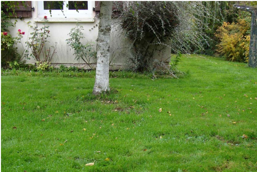
Photo 3 : Photo montrant la mise au jour des fondations à l'angle sud de la maison
