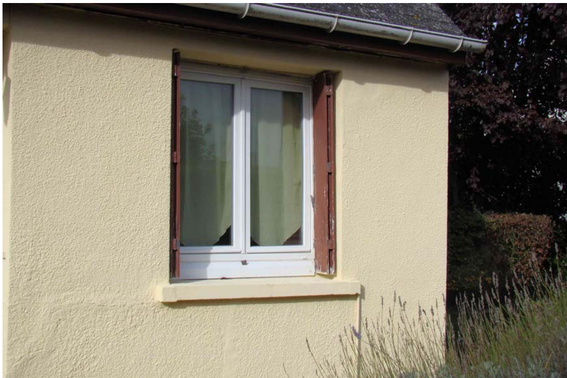
Photo 12 : Fenêtre d'une autre maison touchée plus à l'ouest dans le lotissement
