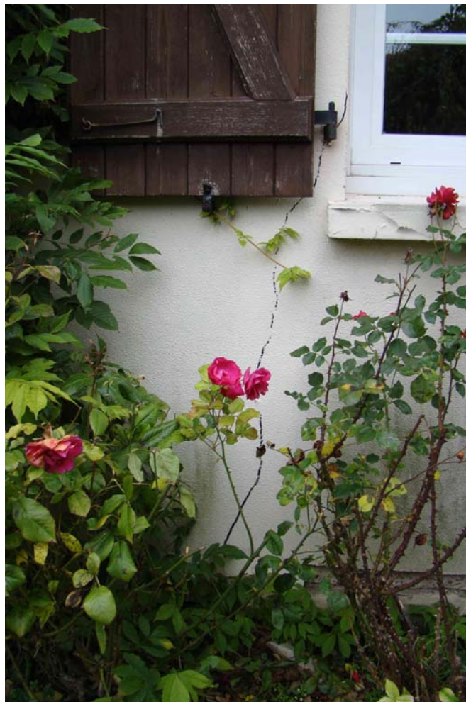
Photo 4 : Fissure affectant la fenêtre la plus proche de l'angle sud
