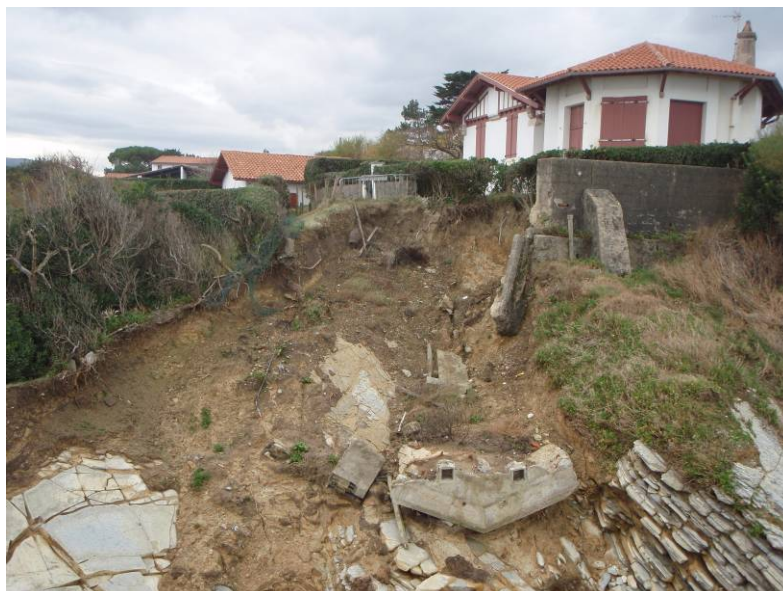
Illustration 44 : Glissement superficiel au sein des altérites (novembre 2009) à la suite de fortes précipitations
