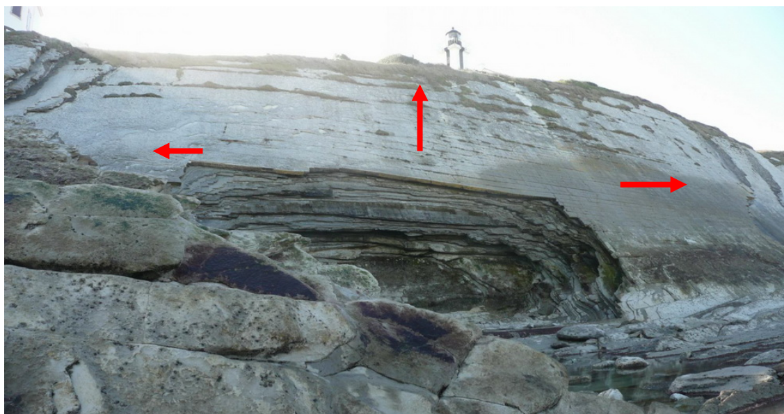
Illustration 55 : Sous-cavage frontal guidé par la fracturation des bancs (les flèches indiquent la progression de la dégradation des bancs)
