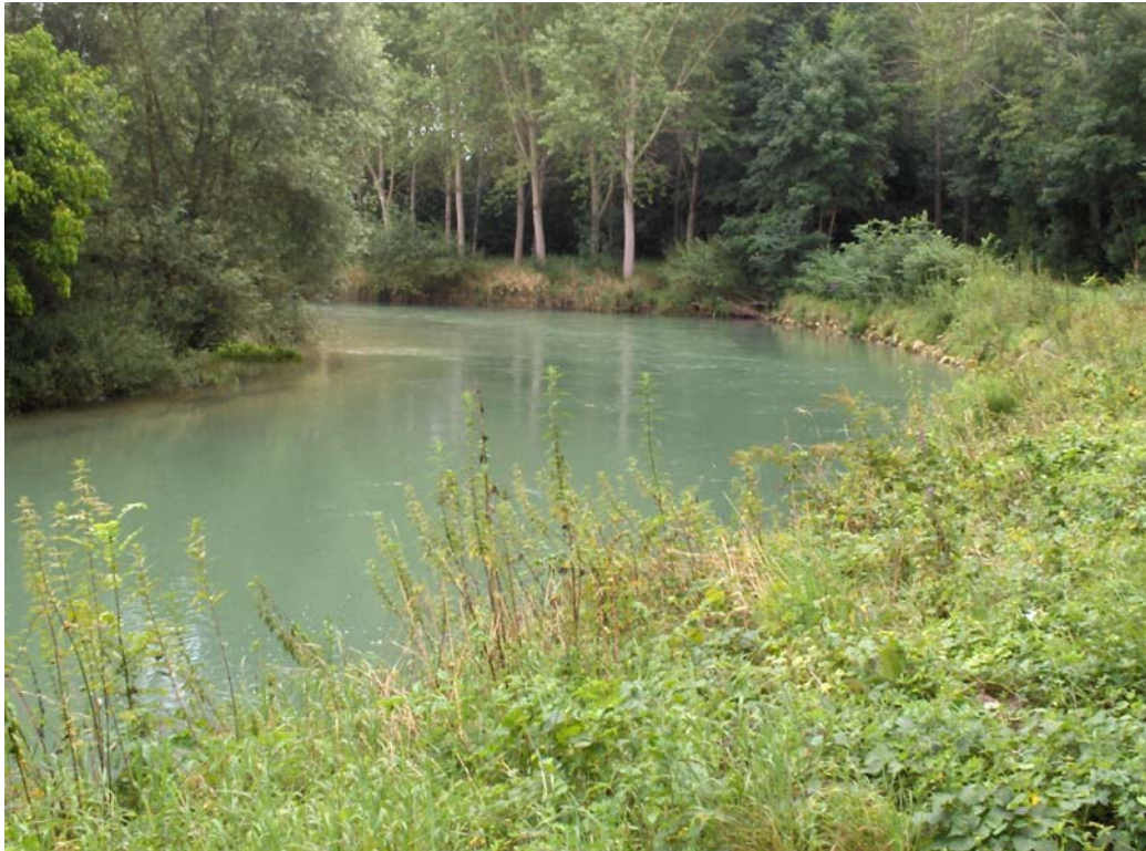
Illustration 19 : Erosion de berge à Torcy le Petit, au creux du méandre principal sur les berges de l'Aube
