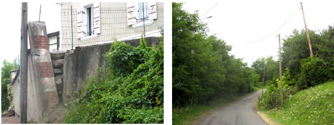
Illustration 12 : glissements de terrain dans la Nièvre (photos BRGM).
