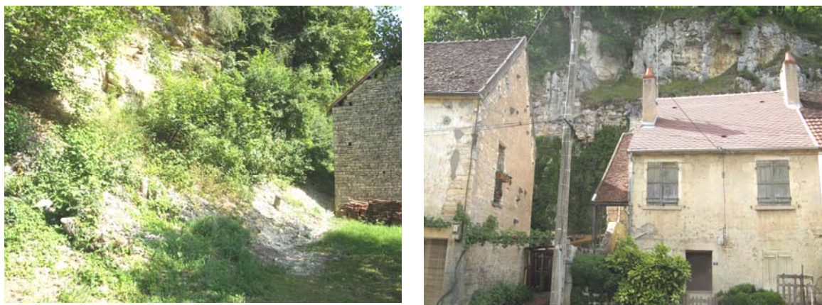
Illustration 14 : falaises dans la Nièvre (photos BRGM).
