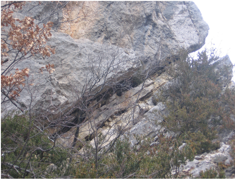
Illustration 16 : le pied lité de la barre supérieure (Photo BRGM)
