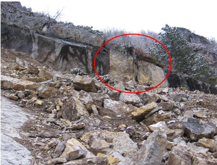
Illustration 6 : autres blocs instables dans l'éboulement (Photo BRGM)
