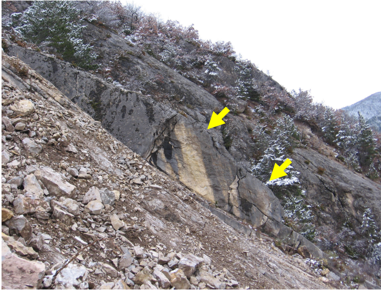
Illustration 5 : Blocs instables dans le front de l'éboulement (Photo BRGM)
