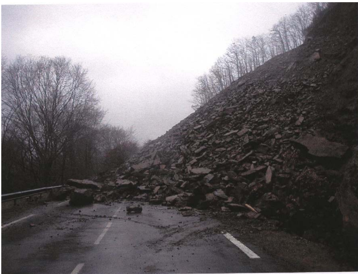
Illustration 21 : Eboulement sur la RD16 entre les communes de Lapeau et de Soursac (2003)
