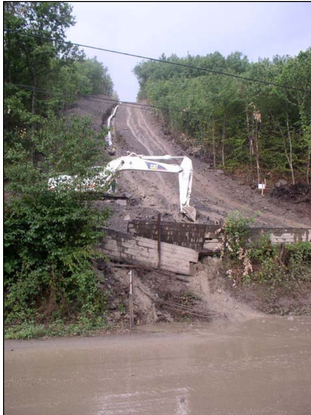
Illustration 29 - Coulée de boue à Saint-Chamond survenue lors de travaux de terrassement (n°64200026) - au premier plan, la RN 498
