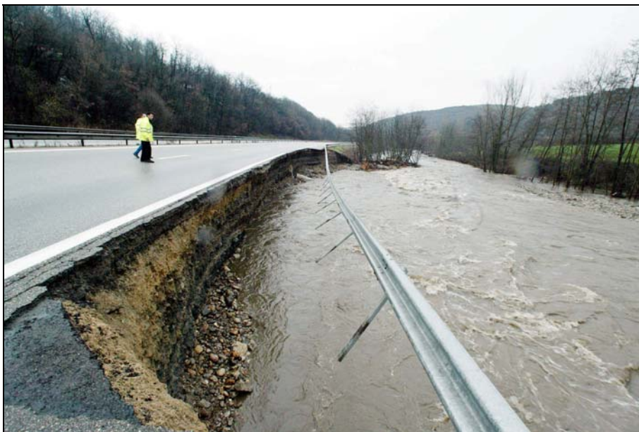
Illustration 25 - Erosion de berge survenue le 2 décembre 2003 sur le Gier et ayant endommagé le talus de l'Autoroute A47 à Tartaras (n°64200195) - Photo DDE
