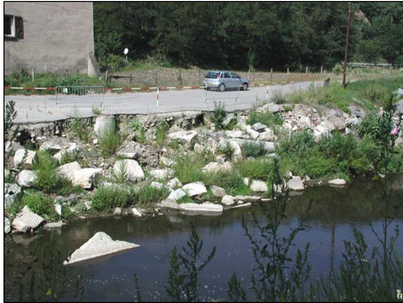
Illustration 26 - Erosion de berge à Dargoire survenue le 2 décembre 2003 (n°64200130)
