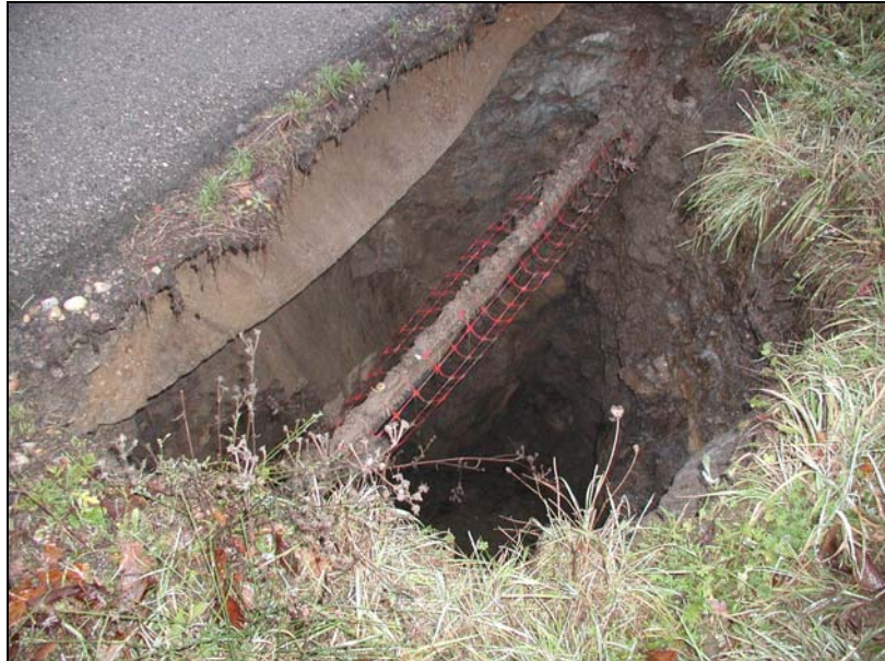
Illustration 34 - Effondrement lié à l'ouverture d'un puits de mine à Saint-Jean-Bonnefonds le 4 décembre 2003 (n°64200056)
