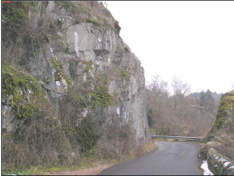
Illustration 32 - Travaux de confortement (grillages, ancrages) réalisés sur une falaise ayant fait l'objet de chutes de blocs à Saint-Jean-Saint-Maurice-sur-Loire (n°64200144)
