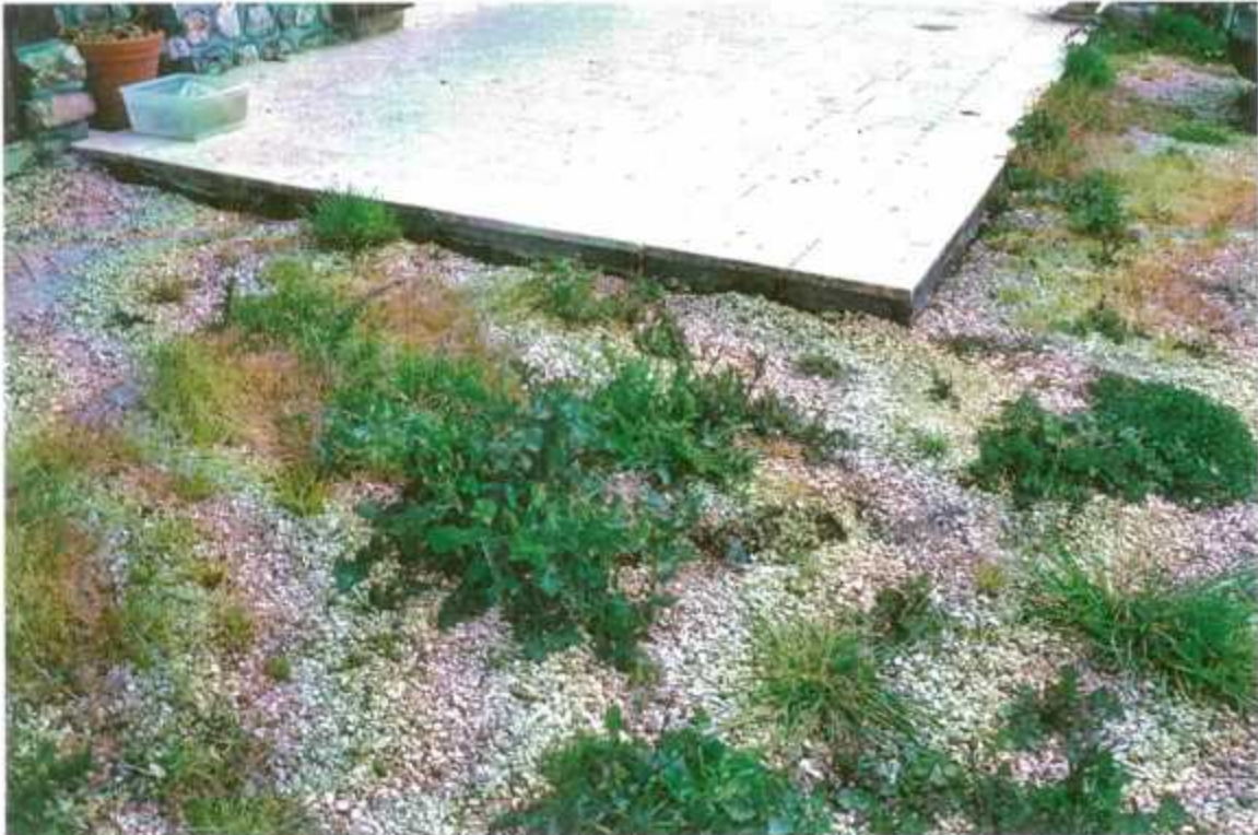
Photo 2 : Vue de l'effondrement principal, parcelle D545, commune de Fort-Moville (27). Détail montrant que l'effondrement se poursuit en bordure sous le dallage externe.
