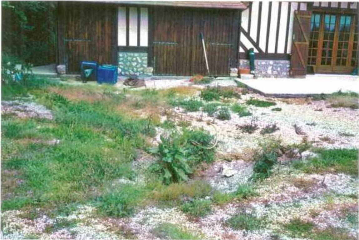
Photo 1 : Vue de l'effondrement principal, parcelle D545, commune de Fort-Moville (27). On notera au premier plan la partie la plus effondrée, associée en bordure à quelques fissures ouvertes de 3 – 4 cm et l'effondrement moins important face à l'entrée de garage.
