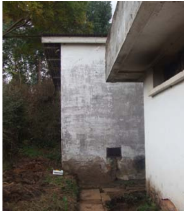
Illustration 18 - Local abritant le forage Ranomafana III
