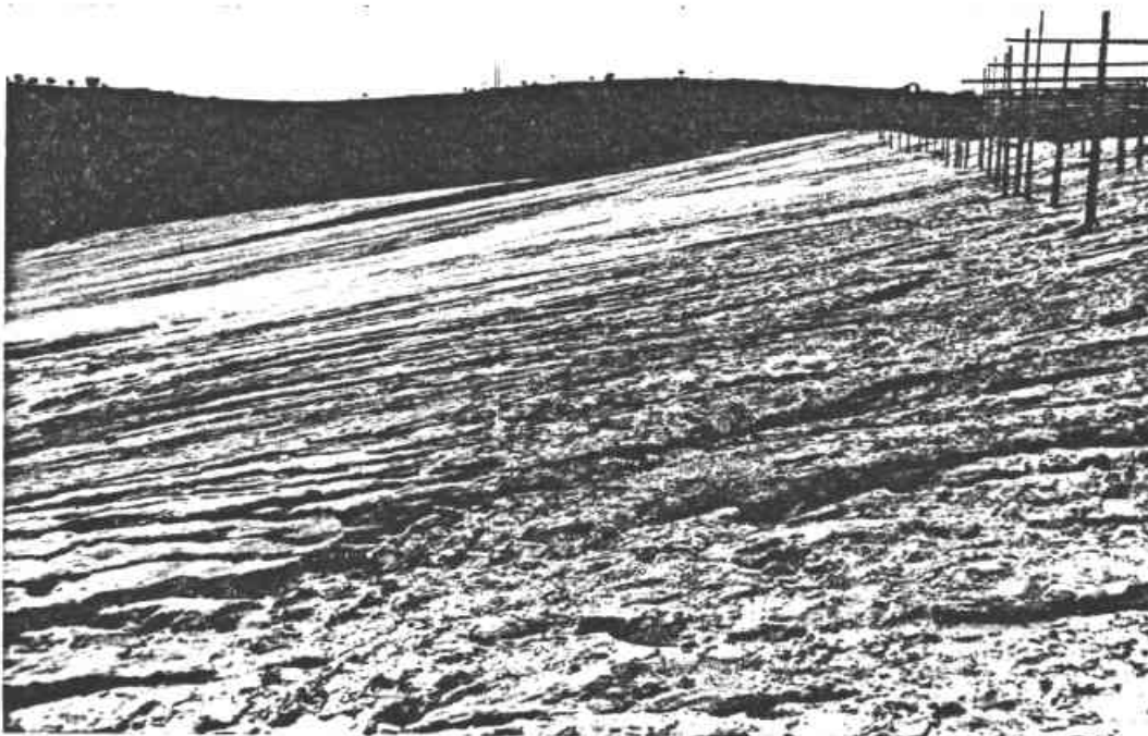
Photo 4 : Talus aval de la digue actuelle (Ravines au premier plan)
