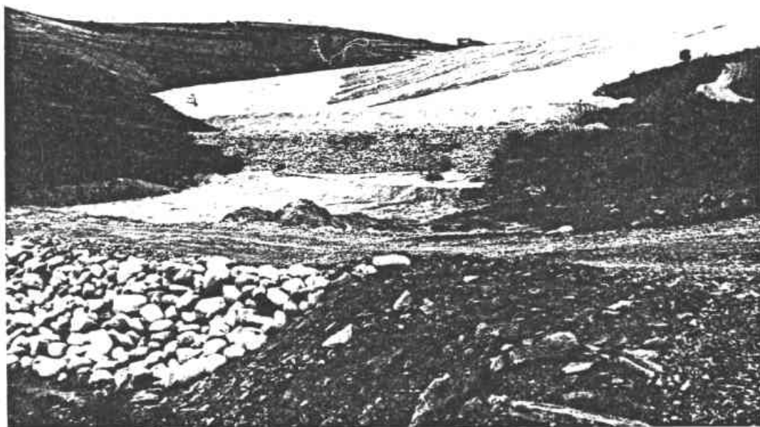
Photo 5 : Barrages filtrants successif en aval du pied de digue pour retenir les sables entraînés lors d'orages violents.
