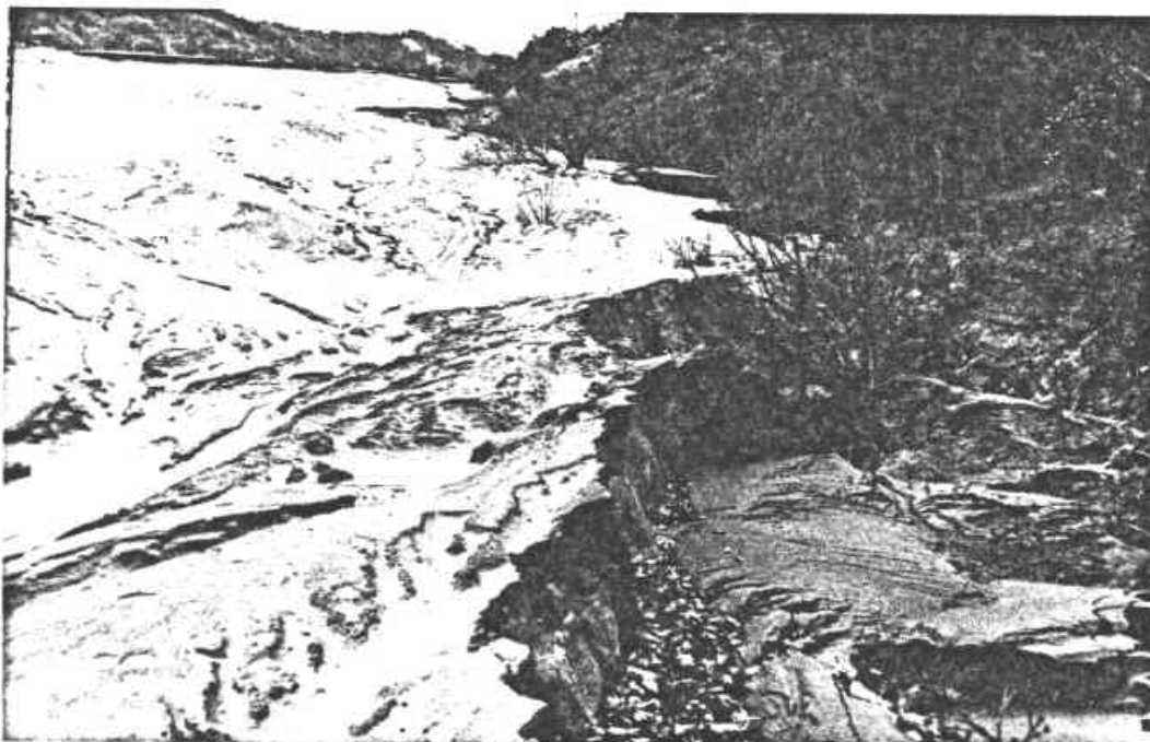
Photo 6 : Ravinement en limite de la digue et du versant naturel rive gauche.
