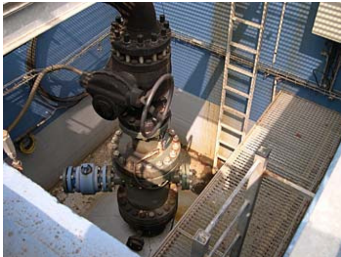
Illustration 8 - © Arene Ile-de-France Tête de puits sur le site géothermique de Chevilly-Larue / L'Haÿ-les-Roses (94)
