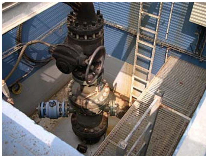
Illustration 8 - © Arene Ile-de-France Tête de puits sur le site géothermique de Chevilly-Larue / L'Haÿ-les-Roses (94)
