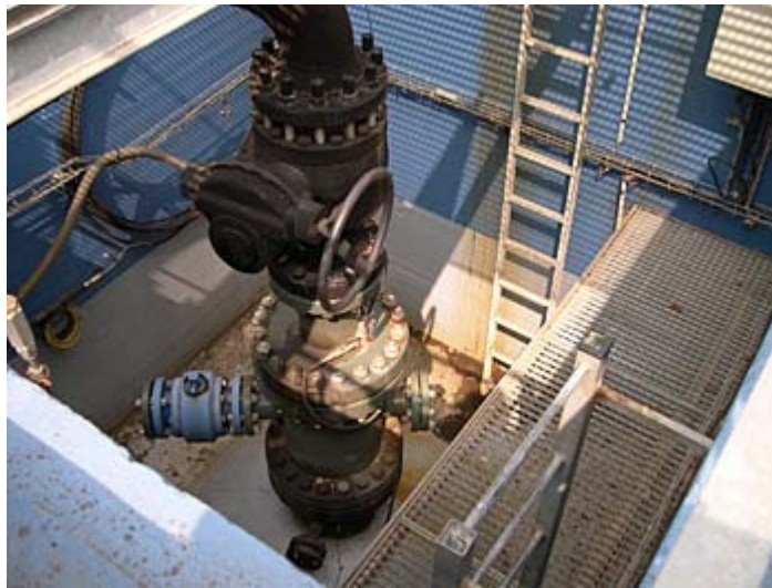
Illustration 8 - © Arene Ile-de-France Tête de puits sur le site géothermique de Chevilly-Larue / L'Hay-les-Roses (94)
