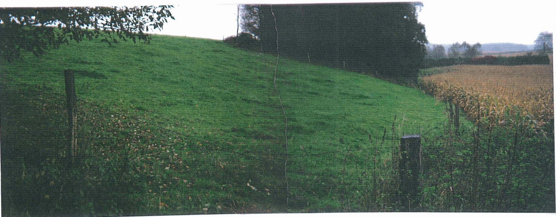
Photo 13 : Ueberstrass - Point N°11 - Mouvements de terrains dans la prairie
