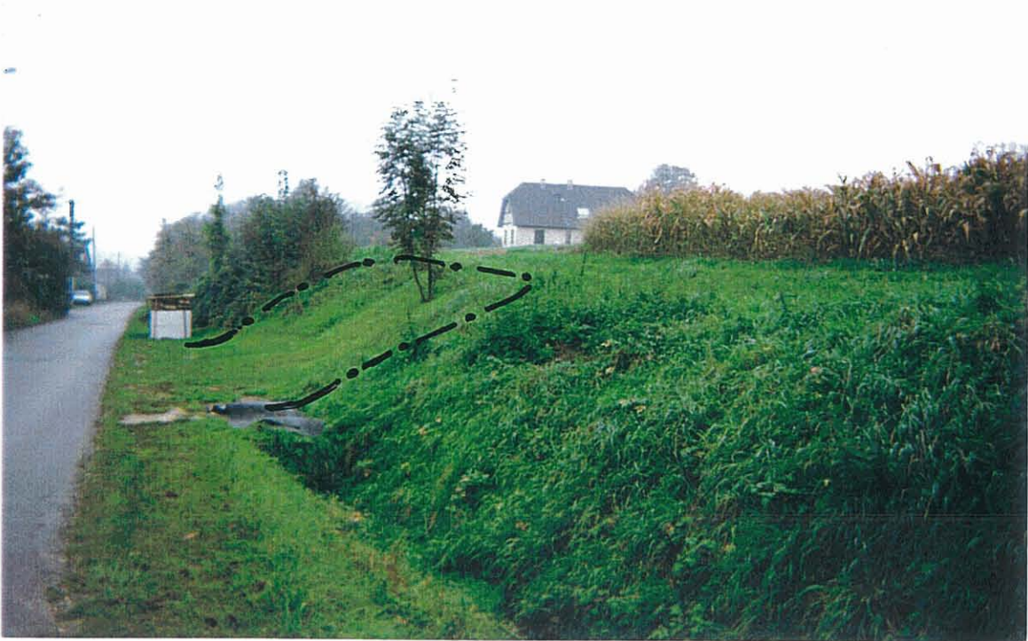
Photo 9 : Heidwiller -Point N° 9 - Localisation de la loupe de glissement sur la route d'Aspach
