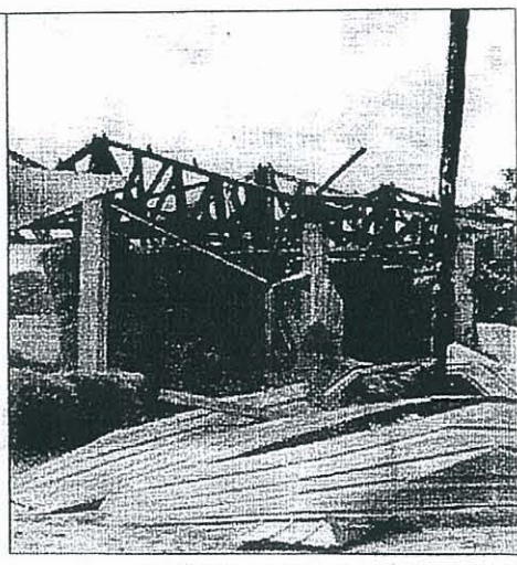
La tornade est passée sur le bâtiment soutenant la toiture qui s'est retournée sur le bâtiment voisin.
