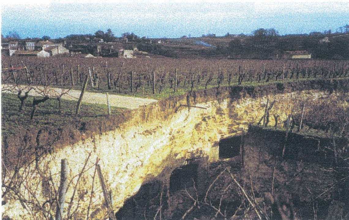
Figure 34 - Effondrement survenu en 1997 dans les vignes de Belair : aspect de la limite d'effondrement (côté nord)
