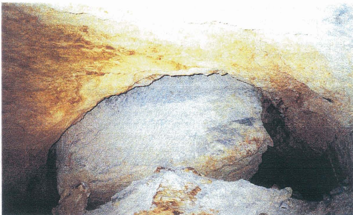
Figure 37 - Poinçonnement de la planche intermédiaire par un pilier du niveau supérieur, en bordure de la zone effondrée à l'est de la parcelle AO 72 (vue prise au niveau intermédiaire)
