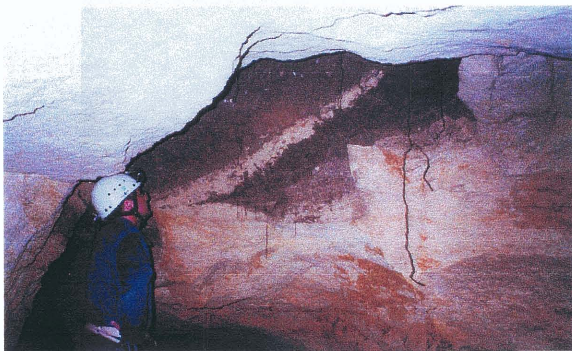
Figure 28 - Amorce de formation d'un fontis au toit du niveau supérieur, à proximité du carrefour entre le chemin de la Pège et la VC n° 10. Présence de terre végétale et de racines au toit de la carrière
