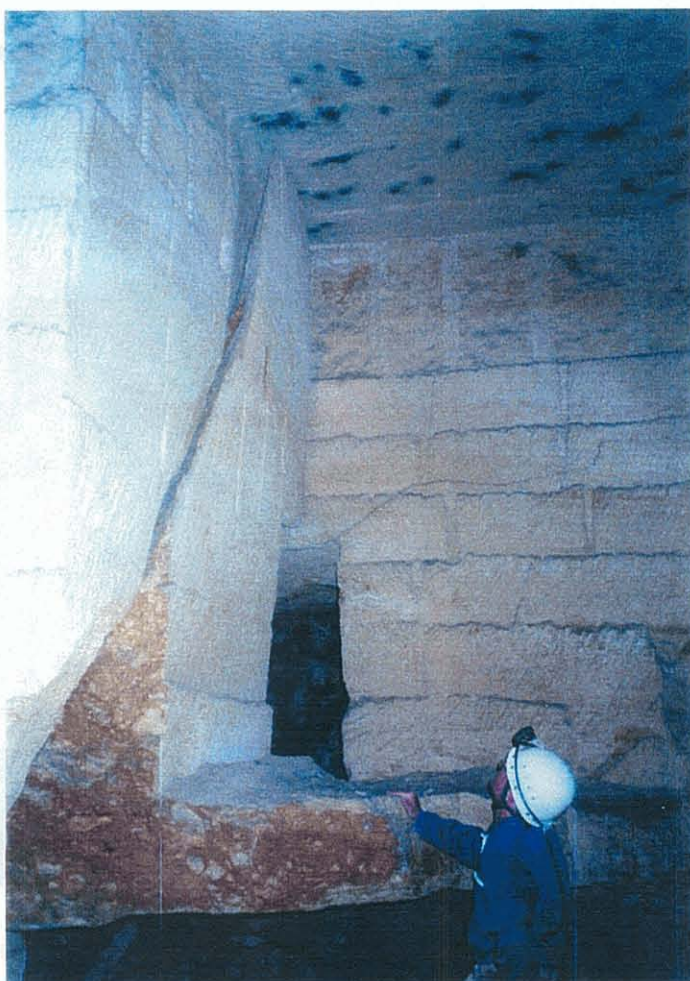
Figure 30 – Fissure diagonale dans un pilier avec amorce de basculement de l'écaille (niveau supérieur, sous le chemin de la Pège)
