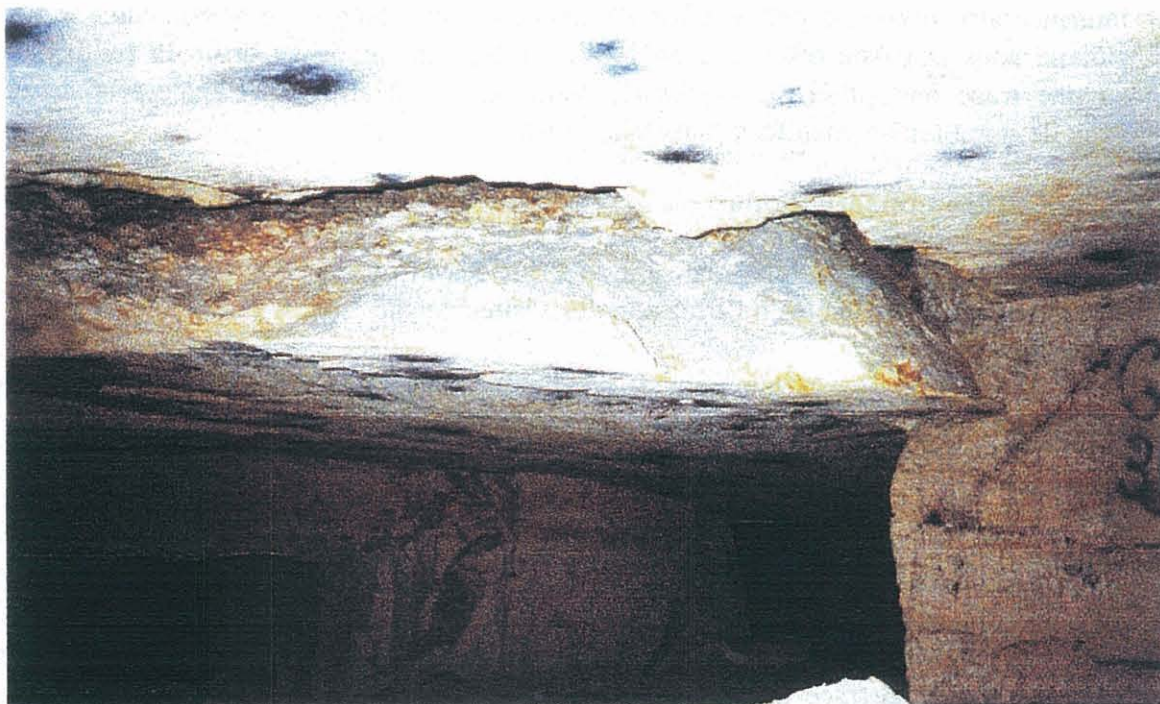
Figure 38 - Descente d'un bloc du toit profondément fracturé sous la zone effondrée à l'est de la parcelle AO 72 (vue prise au niveau inférieur)
