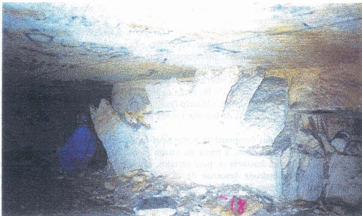
Figure 31 - Pilier éclaté sous l'effet d'une surcharge verticale (niveau inférieur, sous le chemin de la Pège)
