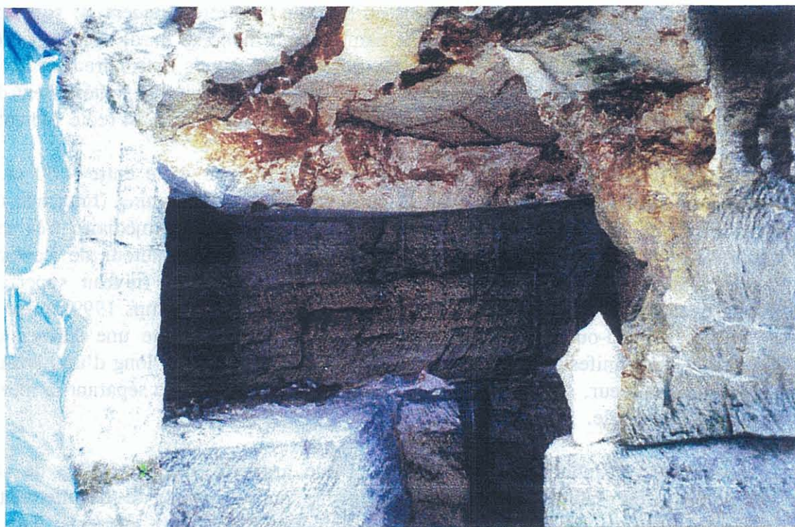
Figure 24 - Toit du niveau supérieur affecté d'une fracturation karstique dense, à proximité immédiate de l'effondrement de 1994
