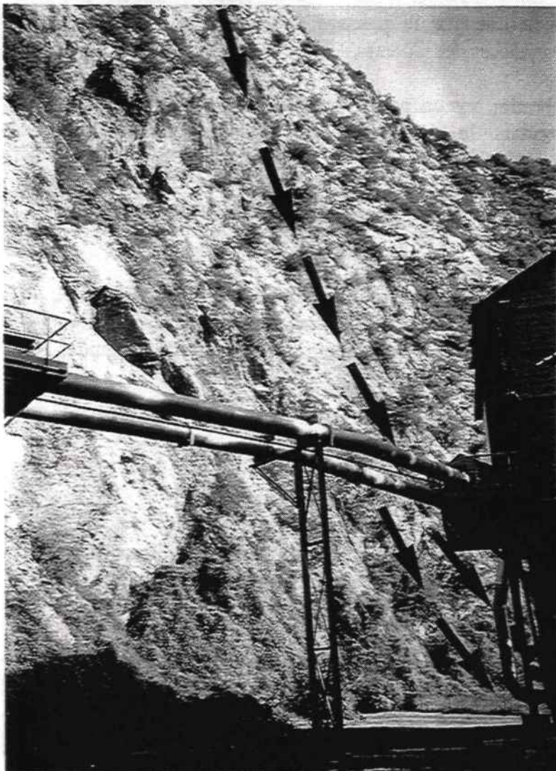
Fig. 3 - Vues générales de l'installation de ventilation (filtres et conduites) et trajectoires des blocs provenant de secteurs élevés.
