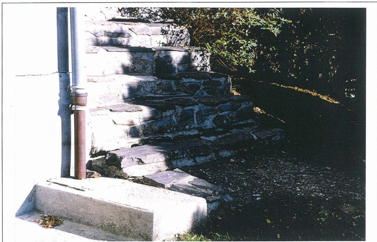
Photo N° 4 - Affaissement première marche de l'escalier
