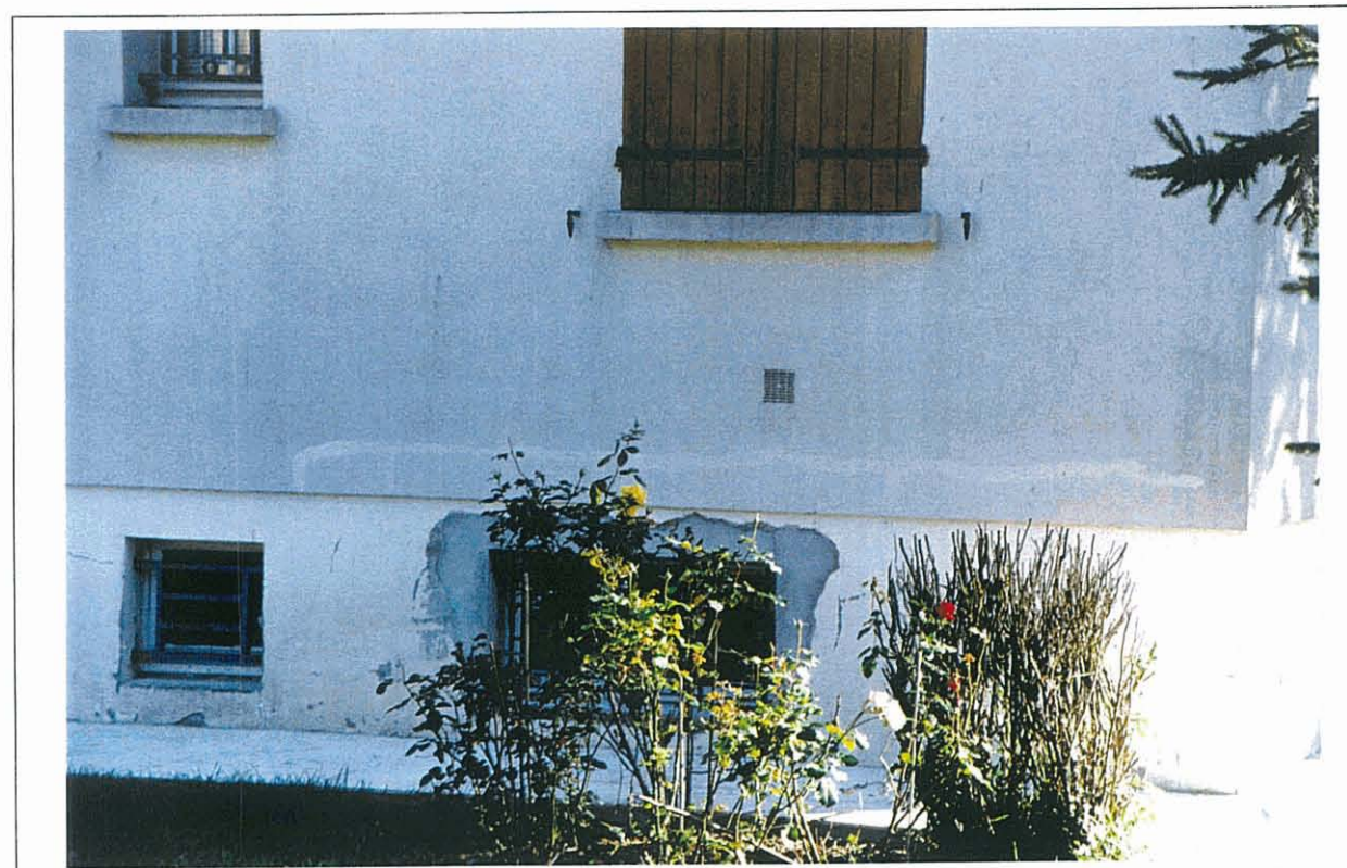
Photo N° 16 - Détail des fissures en façade nord-ouest.
