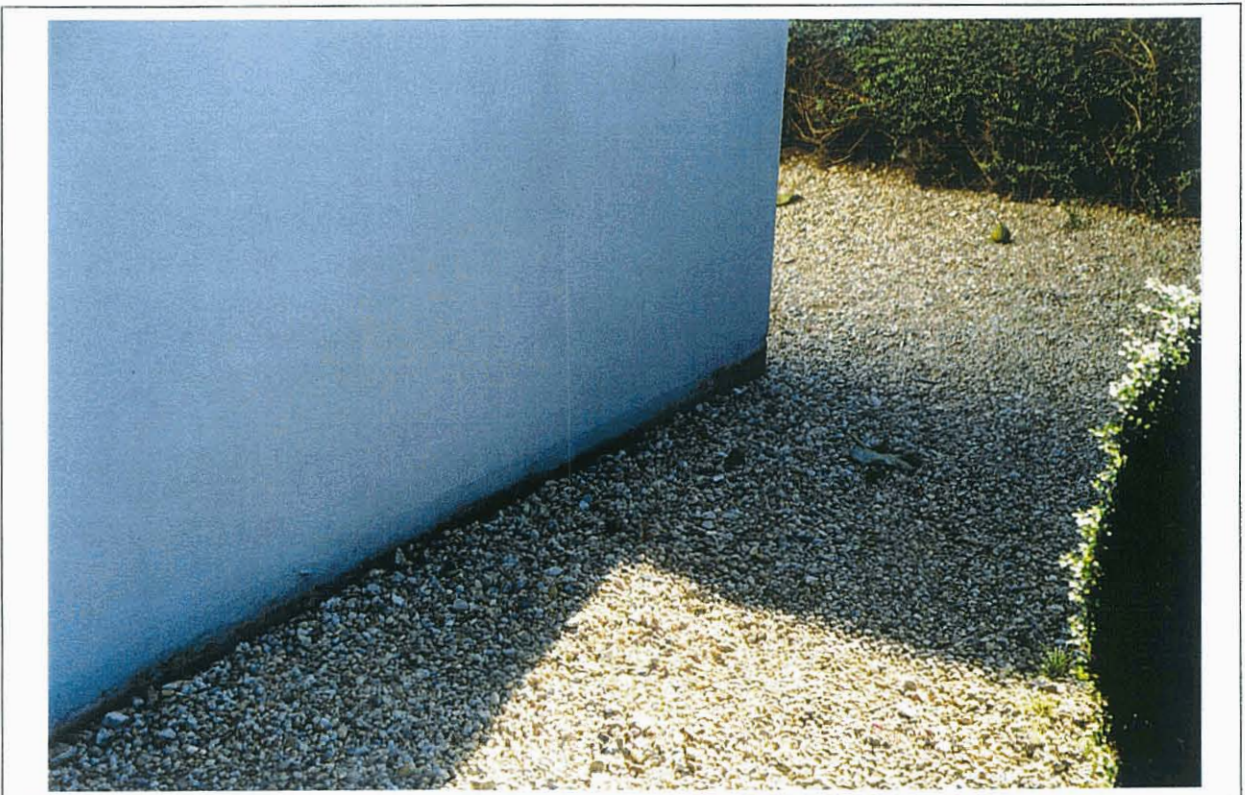
Photo N° 10 - Tassement du terrain le long de la façade nord-ouest par dessiccation.
