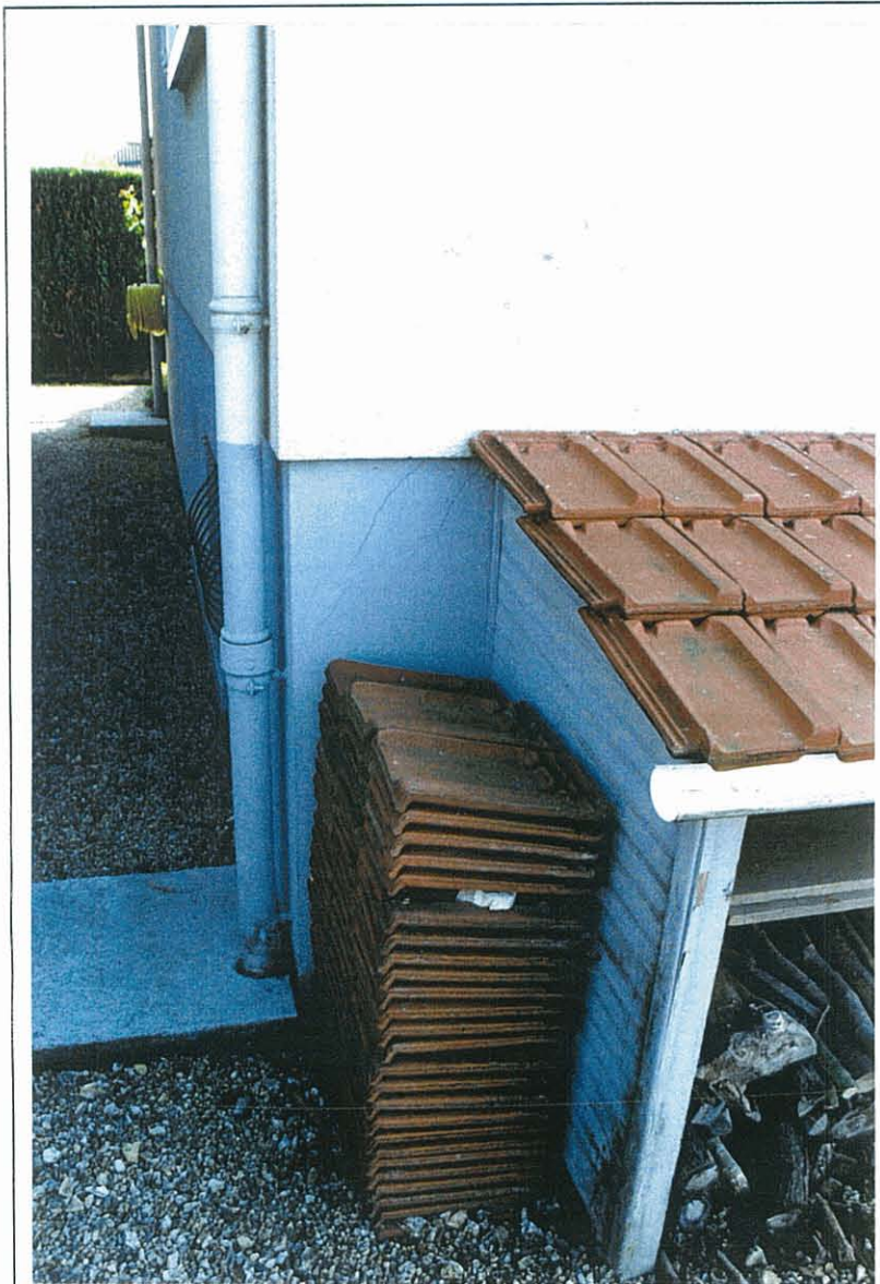
Photo N° 13 - Fissures inclinées à ~ 45°.
