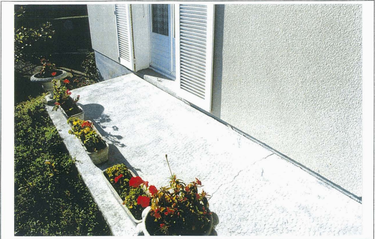
Photo N° 9 - Décollement et fissuration de la terrasse.
