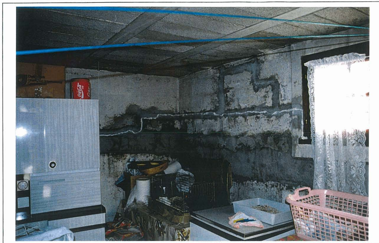
Photo N° 5 - Lézardes récentes et anciennes. Décollement du plancher haut.
