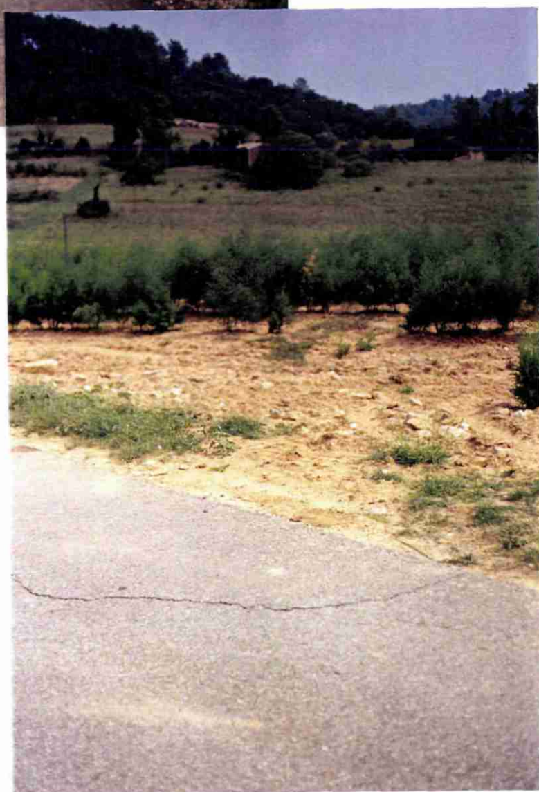
Photos 7 et 8 : Effondrements sur la route N8
