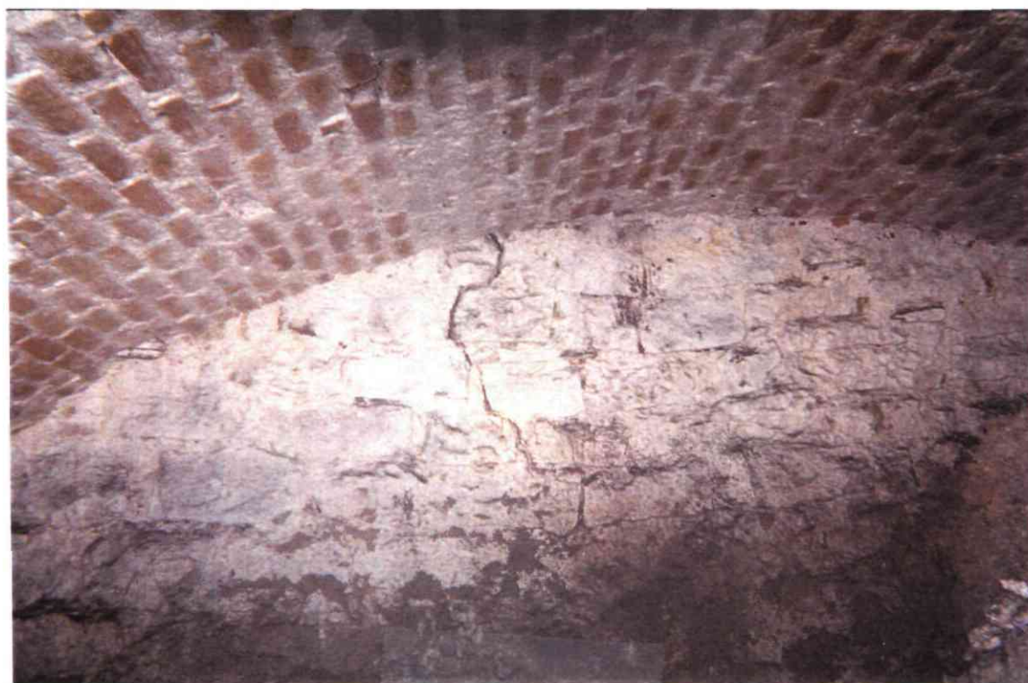
Galerie 8 - Fissure dans le mur ouest de la galerie
