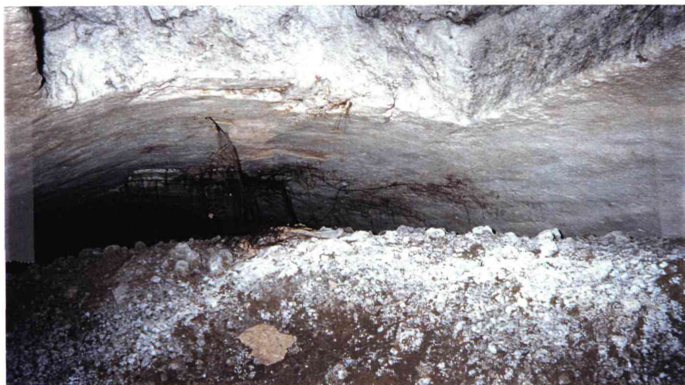
1, rue d'Epernay - Galerie 10. Remblai et racines dans les fissures de voûte.
