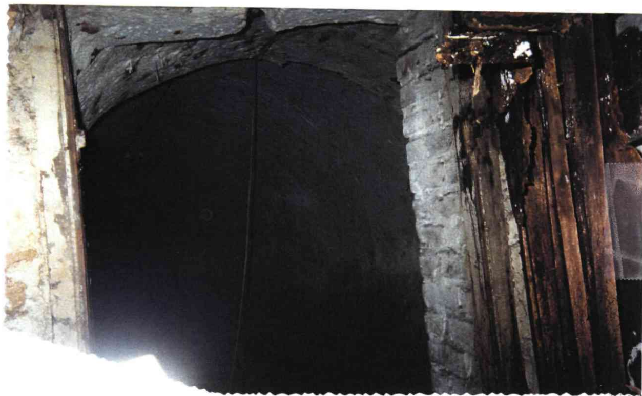
Rue de Champagne nord : Vue générale avec bois pourri
