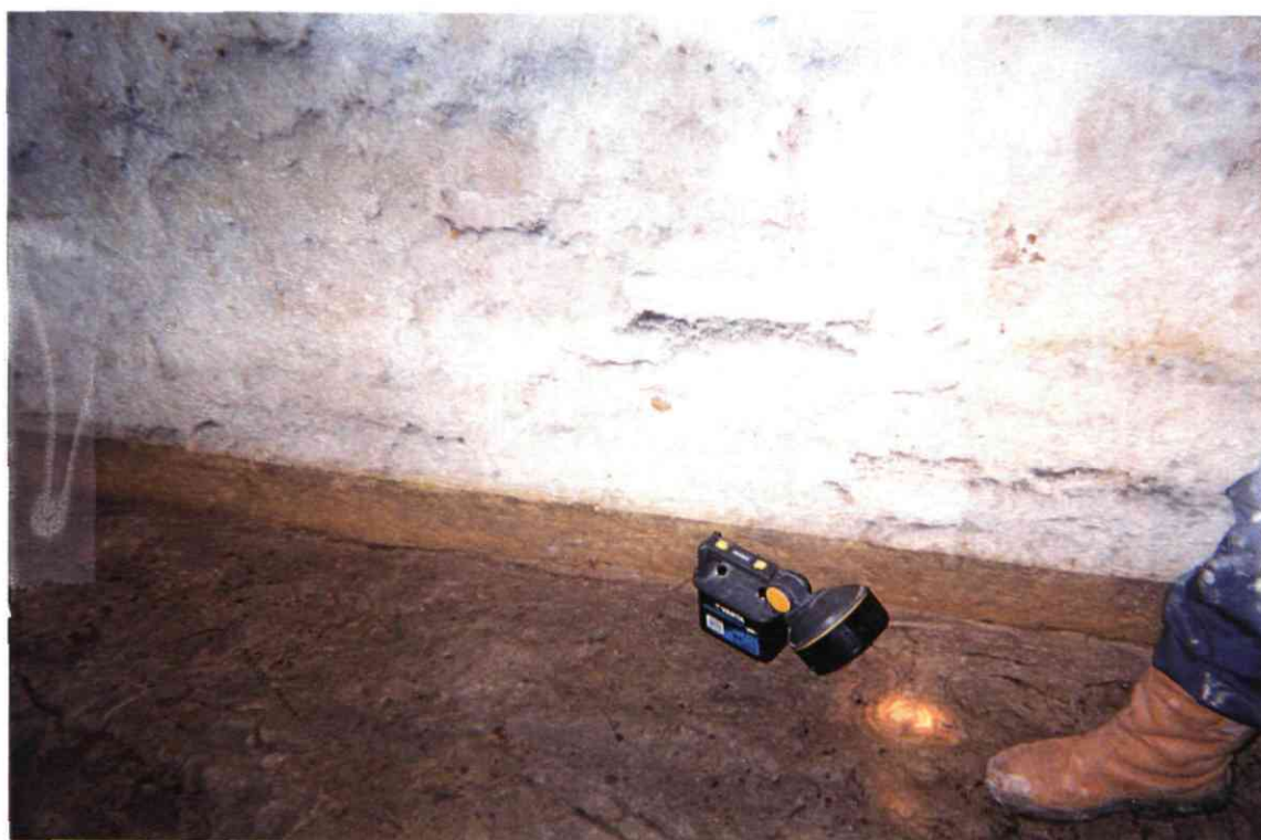
Rue de Champagne Nord - Galerie 28. Limon sur le sol et trace d'inondation
