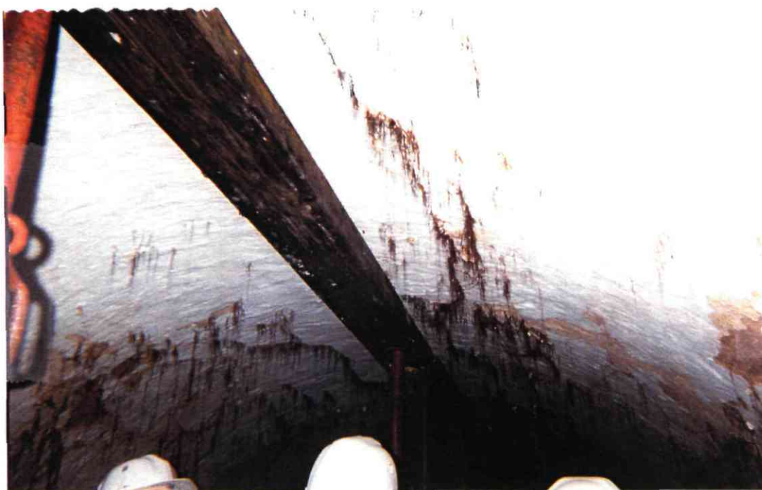
Rue de Champagne Nord - Galerie 26. Soutènement et racines en voûte
