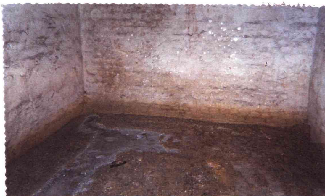
Galleries 28 et 29 : Trace d'inondation avec marque sur les murs
