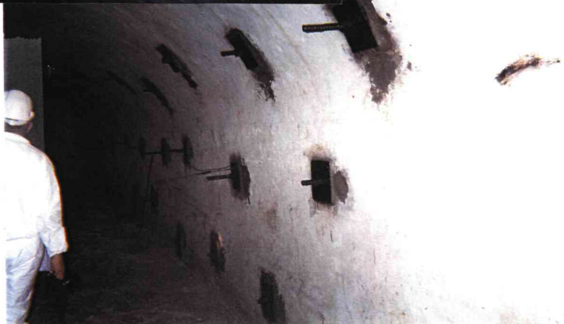
Rue de Champagne Nord - Galerie 31. Consolidation par tirants
