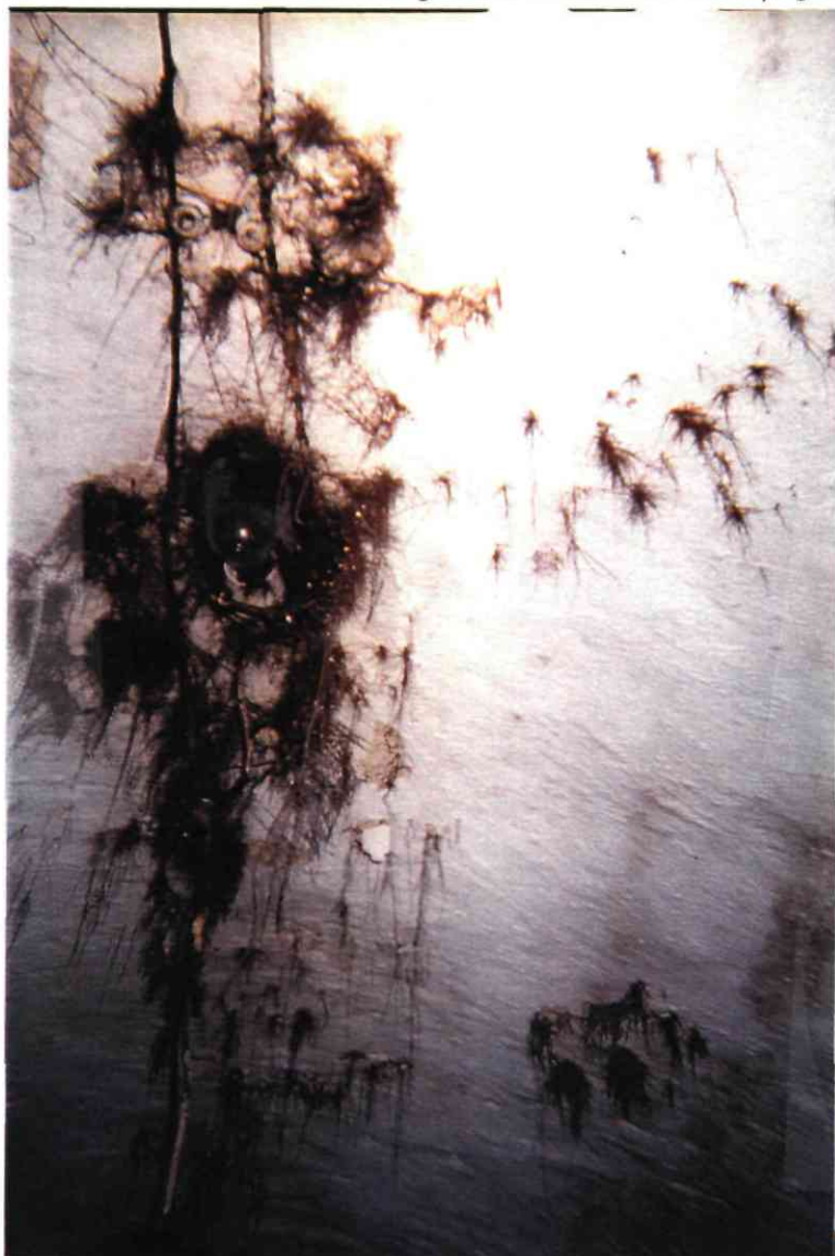
Rue de Champagne Nord. Galerie 27. Racines en voûte
