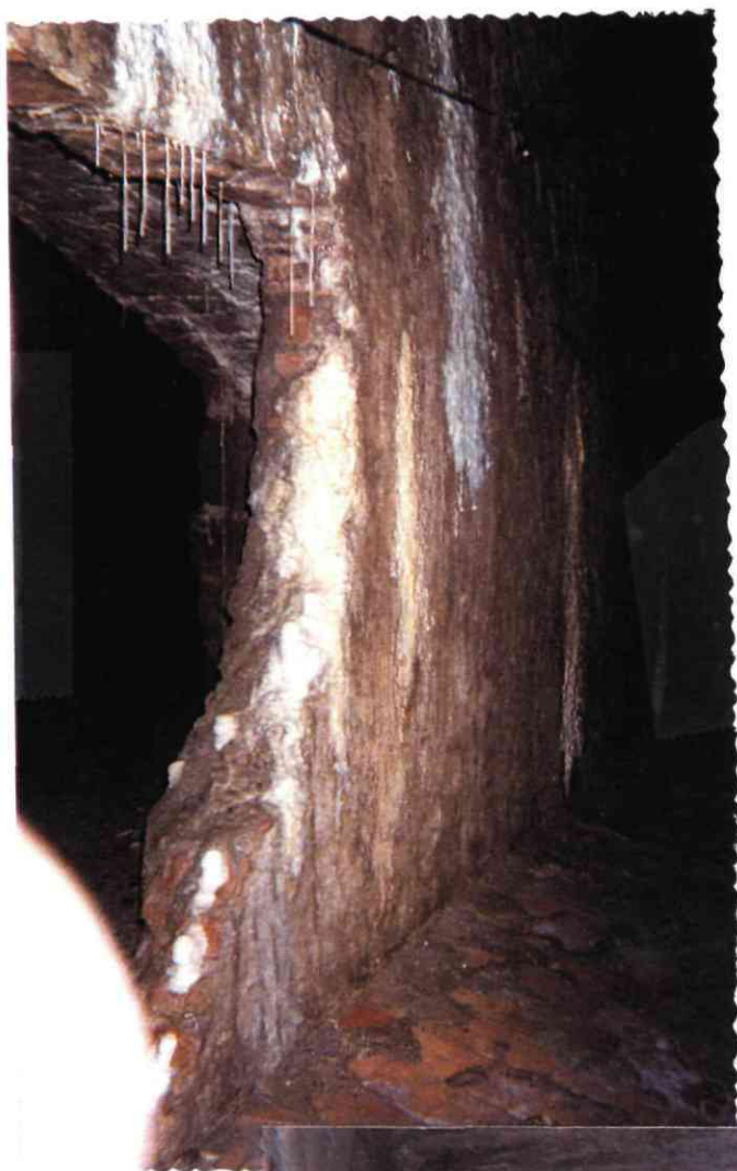
8, rue de Champagne : Cassure du mur entre les galeries 13 et 5. Stalactites de salpêtre
