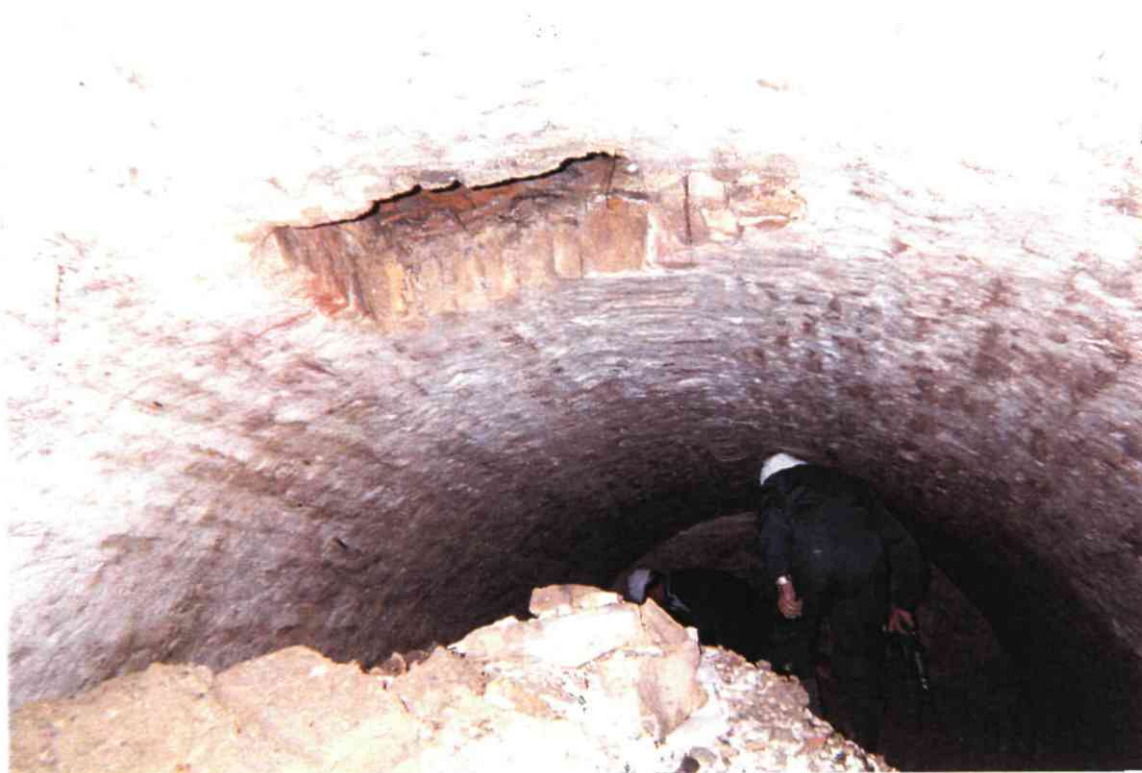
Galerie 7 -Cone d'éboulis sous cheminée. Lors d'une rupture de conduite du réseau en 1994, l'eau a inondé les galeries par cette voie.
