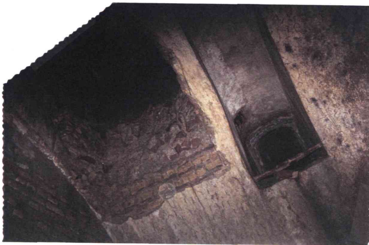
8, rue de Champagne - Galerie 15. Ancienne trémie et cheminée de ventilation
