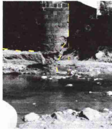
Affouillement et érosion d'une culée du pont de la rivière St Etienne
