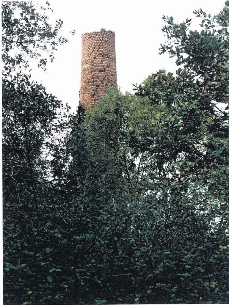
Photo 13 Site 6 : Vue de la partie supérieure de la cheminée ; on aperçoit les briques instables et les lézardes qui menacent la stabilité de la construction
