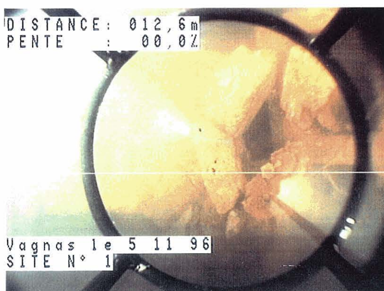
Photo 7 - Site 3 : Aperçu des blocs accumulés dans la structure métalliques, formant un bouchon partiel à 12,6 m de profondeur, sous l'eau.
