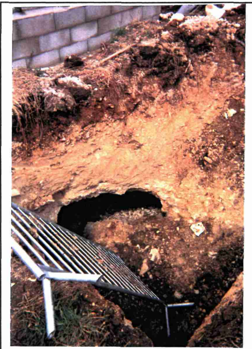
Départ d'une galerie sous les fondations d'une maison en cours de construction.
