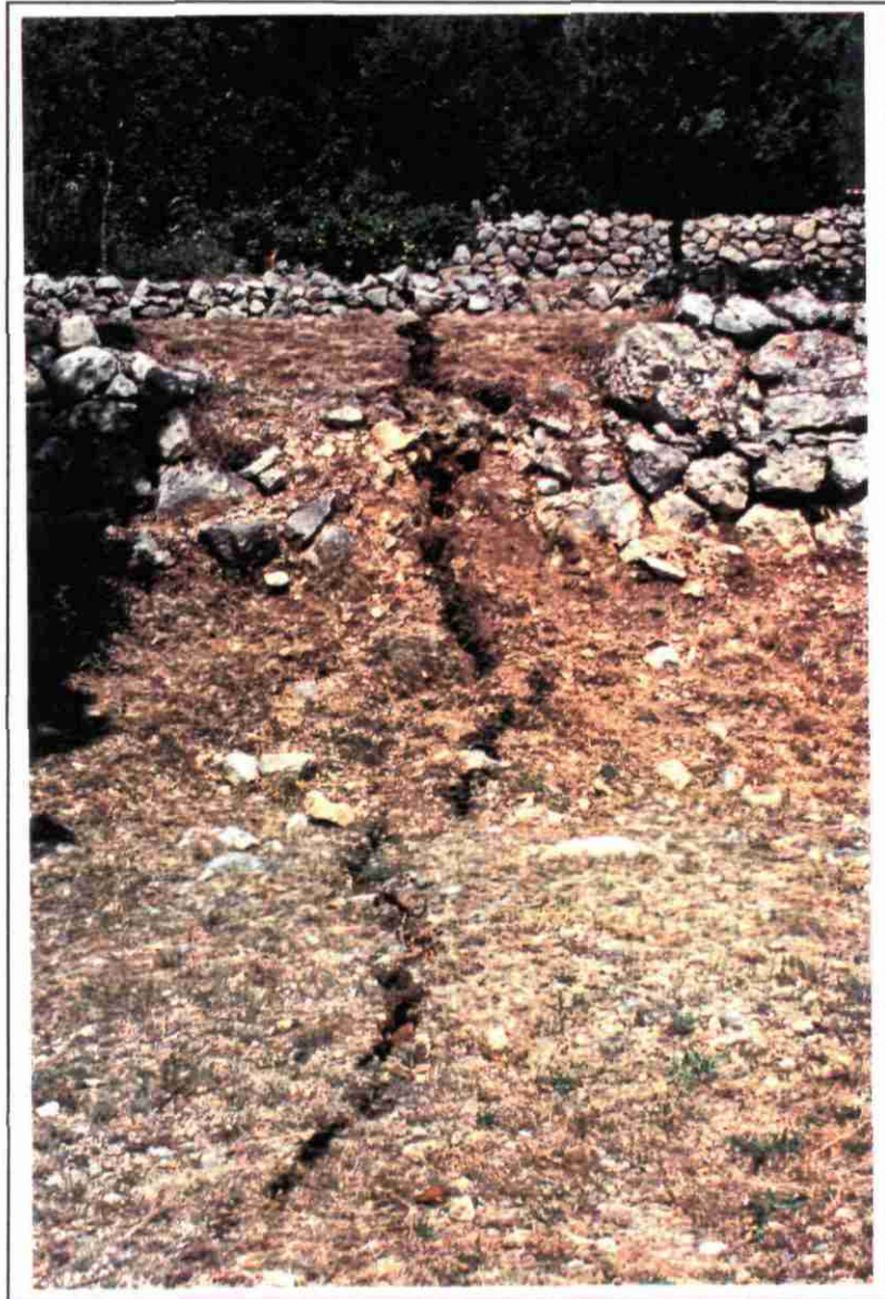
Fig. 11 - Fissures en retrait de la zone effondrée
