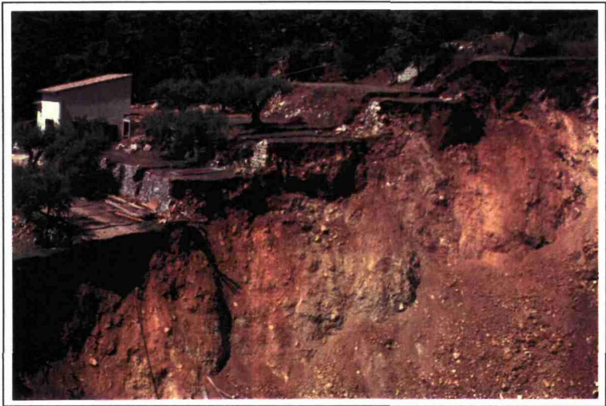
Fig. 5 - Effondrement de Bargemon
