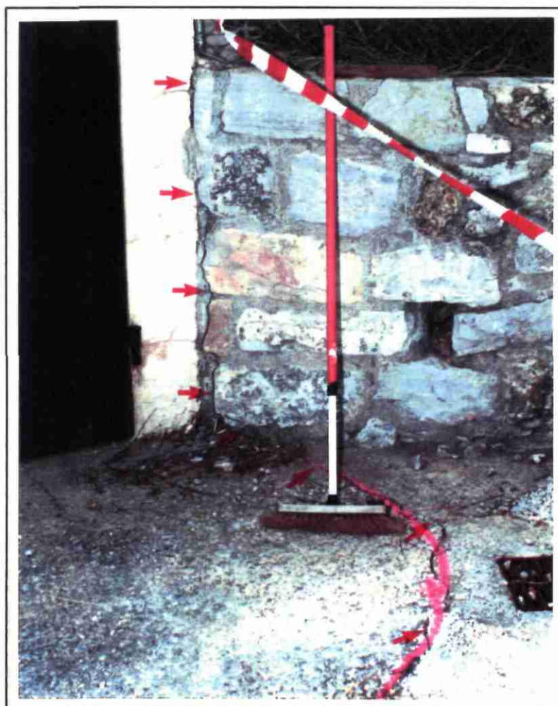
Fig. 16 - Fissuration du bâti
