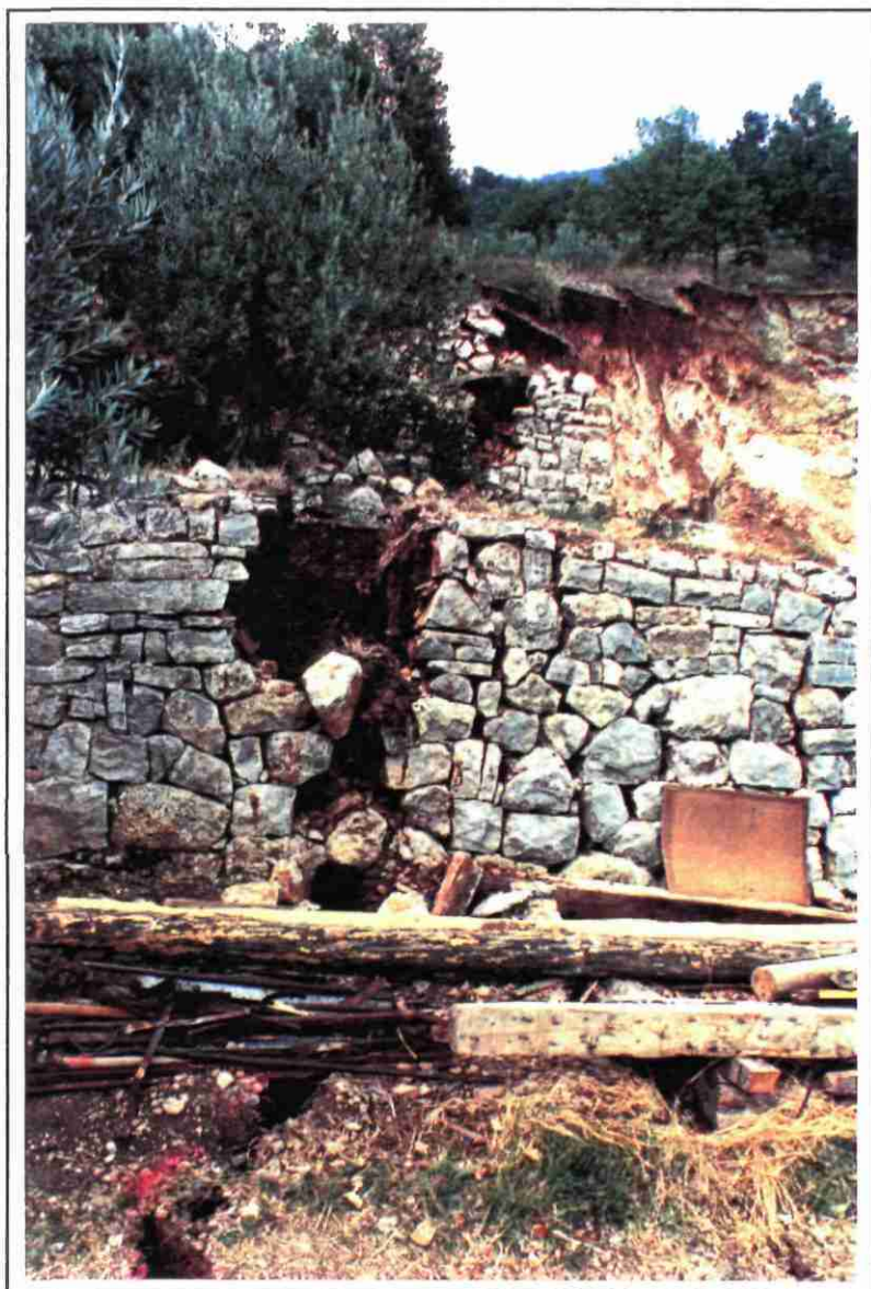
Fig. 7 - Fissures en retrait de la zone effondrée
