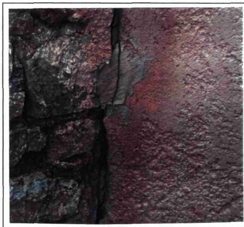
Fig. 18 - Fissuration du bâti
