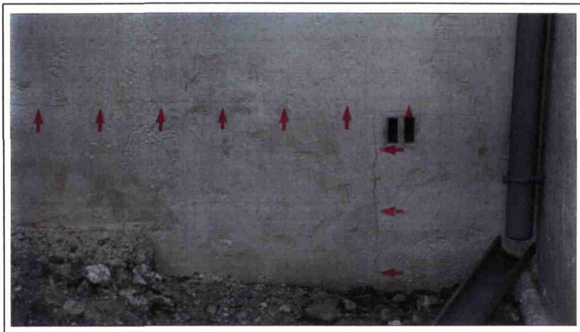
Fig. 15 - Fissuration du bâti
