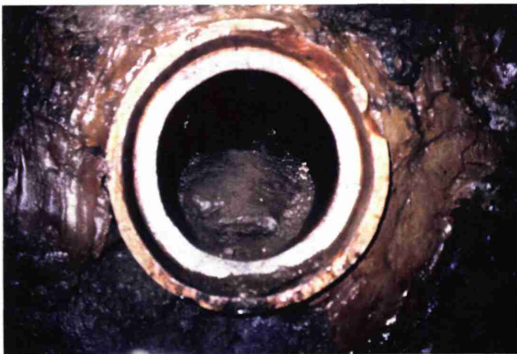
EMPRADES : Tuyau de trop-plein comblé par des dépôts argilo-sableux et des cailloutis
