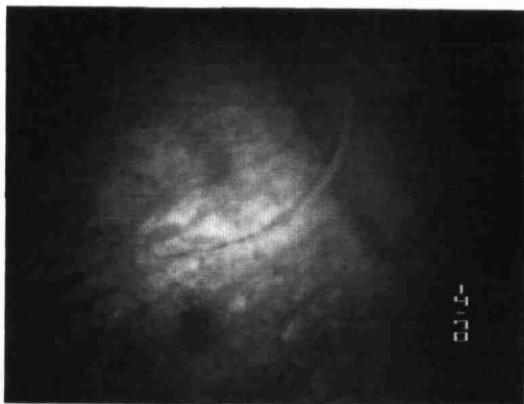
ARPAJON F18 : Fond de l'ouvrage, avec paroi crépinée totalement occultée par les incrustations et remblai (en haut à gauche) - Collier Rilsan déposé au fond
