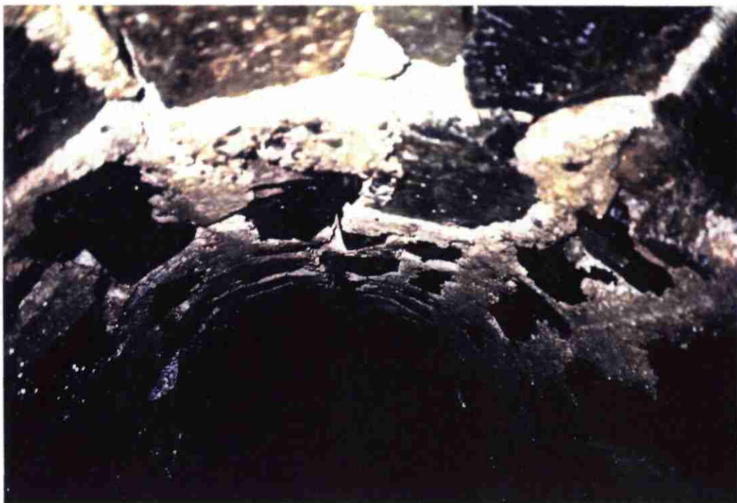
LAVERGNE-NEGRE : fissuration longitudinale de la voûte (moellons déchaussés) sans trace de percolation (vers 90 m)
