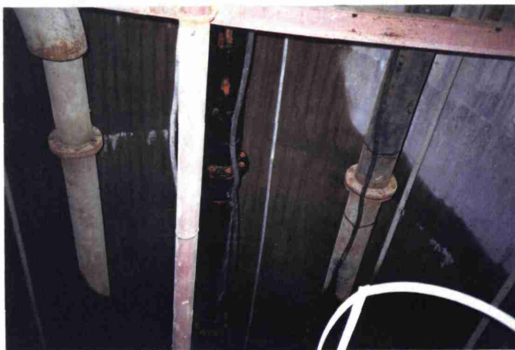
LAPRADE (station) : Colonnes d'exhaure des trois pompes immergées (120, 150, 180 m 3 /h). A l'arrière plan : tringles de commande des drains n° 4, 6 et 7 (de gauche à droite)
