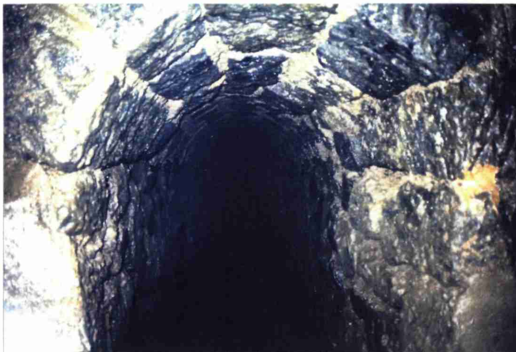
EMPRADES : Départ de la galerie près de la chambre de captage Mortier altéré entre les moellons, surtout à droite
