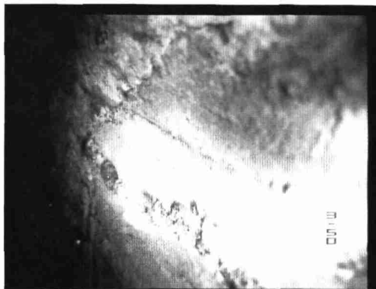
CLAVIERES F4 : Vue latérale : début du crépinage, colmaté ici par des dépôts ferrugineux écoulés depuis un raccord poreux à 2 m
