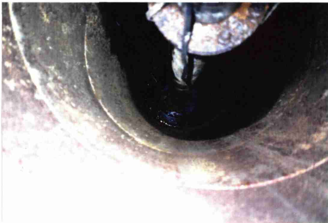
CLAVIERES F4 : Tête de forage. Noter les infiltrations superficielles à partir du quatrième élément (raccord horizontal oxydé et poreux)
