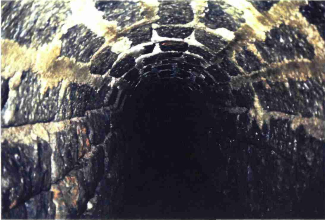
LAVERGNE-NEGRE : Galerie vers 150 m, en très bon état. Moellons taillés et mortier en bon état. Quelques oxydations localisées (à gauche)
