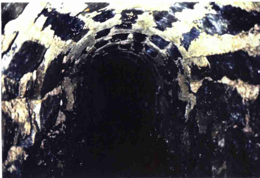
LAVERGNE-NEGRE : Vue de la galerie vers 30 m - Voûte maçonnée avec un mortier en bon état
