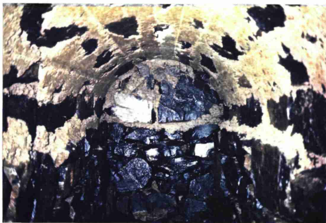
EMPRADES : Extrémité murée de la galerie à 65 m - Voûte fortement colmatée par du mortier
