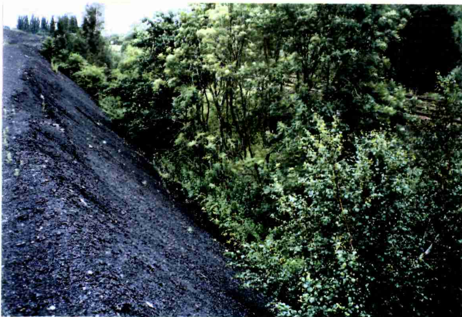
Photo 4 - Fossé ouest en bordure voie SNCF partiellement remblayé par le matériau de ravinement
