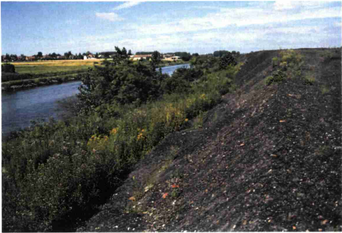
Végétation envahissant le talus de bordure sud
