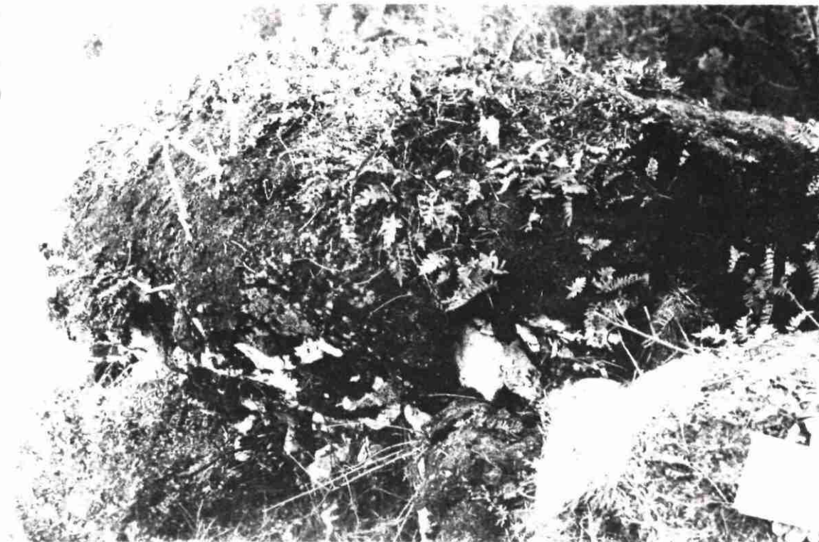
Cliché n° 11 Ecaillage 2a vue de dessus, côté amont
