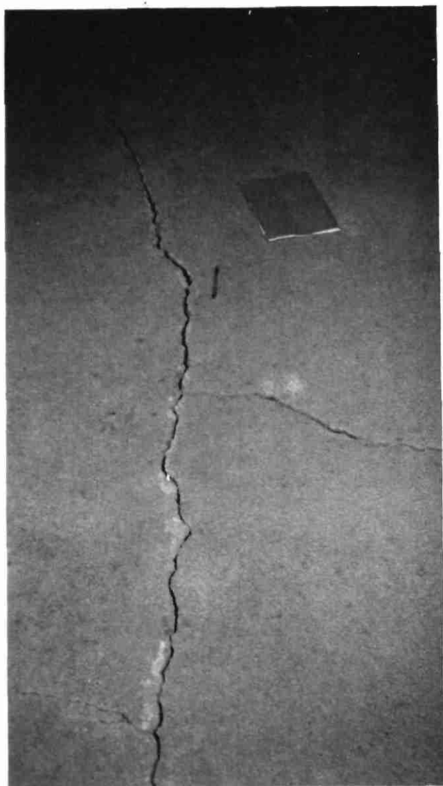
Maison de Mr COURTOIS (en haut) : Affaissement de la terrasse de 5 à 6 cm.
