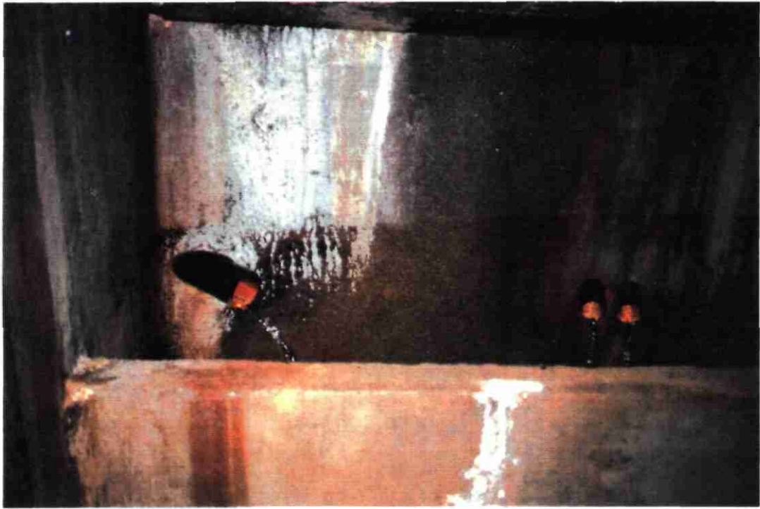
5 - Massignolles n° 2 - Infiltration par joint supérieur Eaux ferrugineuses
