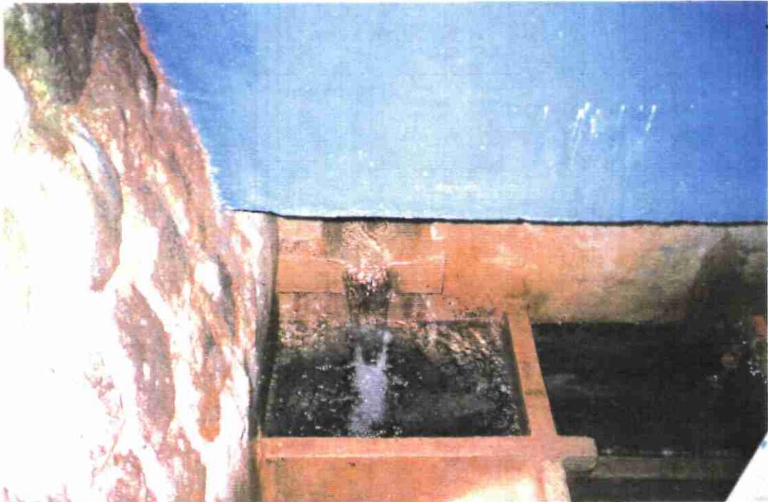
4 - Tunnel des Bouchauds - débit = 86,7 l/mn (16/10/90)
