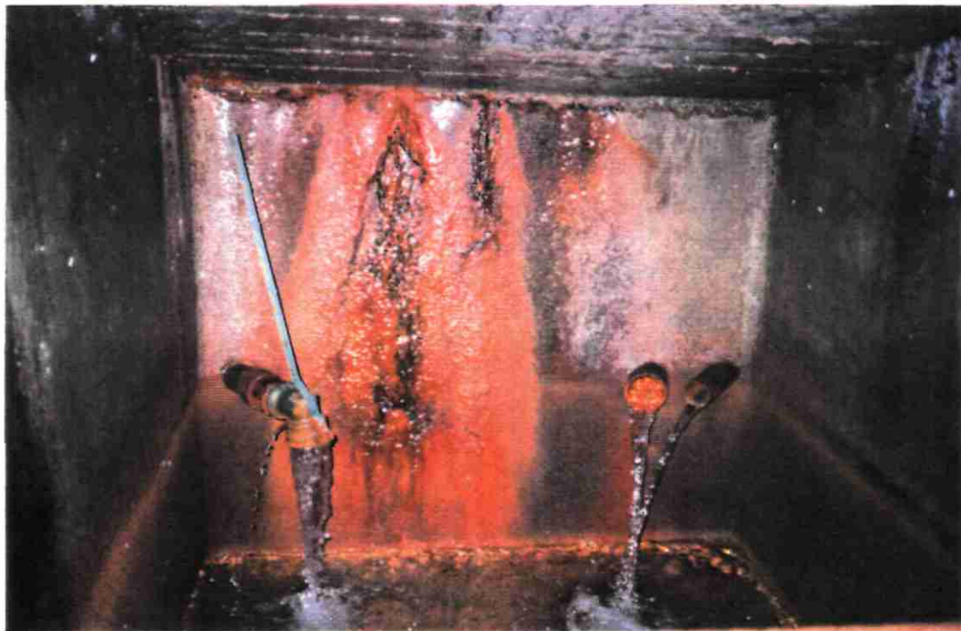
6 - Massignolles n° 3 - Infiltrations ferrugineuses Arrivée Massignolles n° 2 au centre
