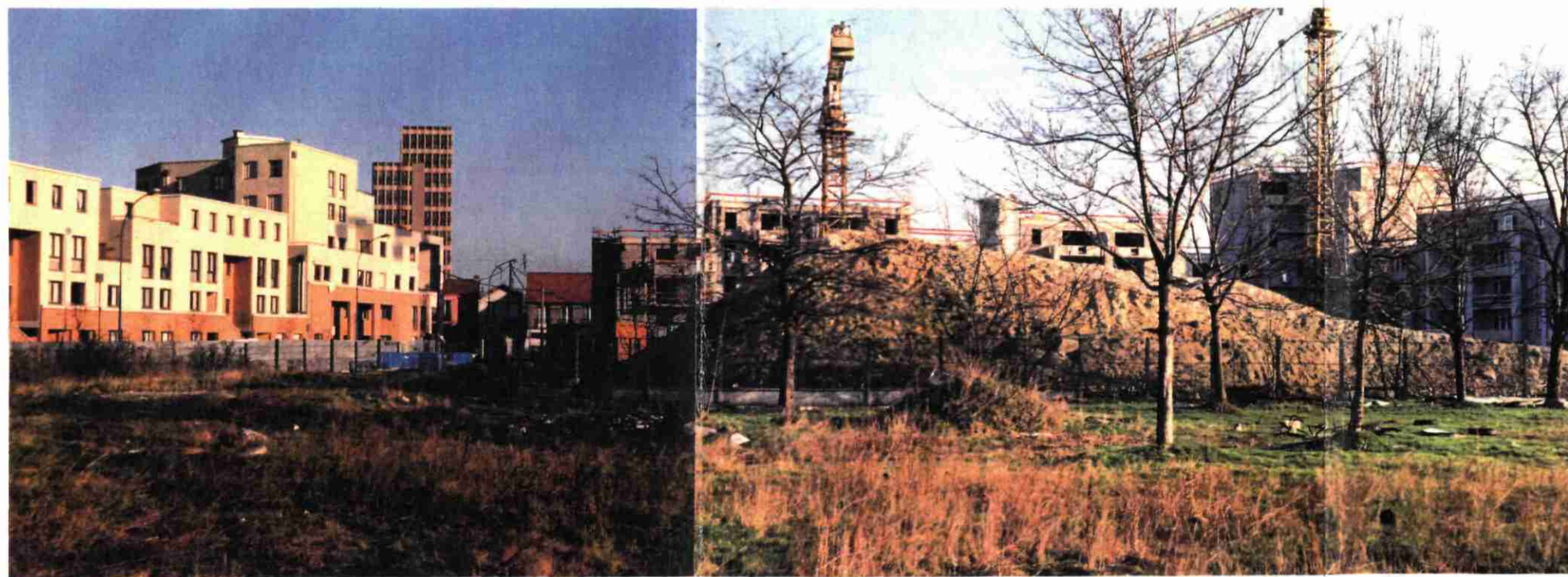
VUE DU SITE EN DIRECTION DU NORD Les immeubles en construction bordent la rue de l'Union, à gauche de la photo la rue du Moulin Neuf.
