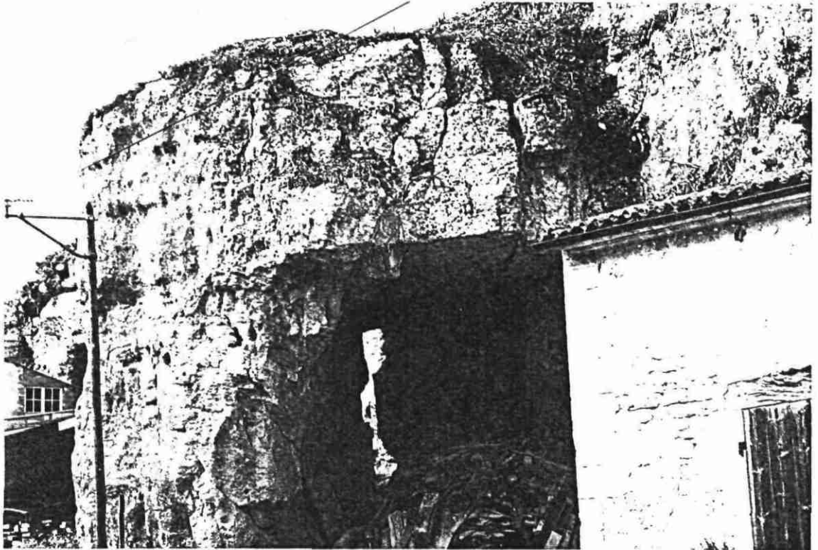
Ancien effondrement à l'entrée de la carrière Interdire et fermer l'accès par clôture
