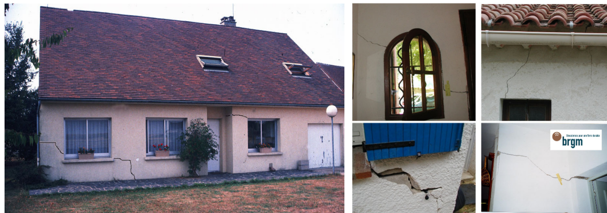
Figure 19 – Exemples de désordres
