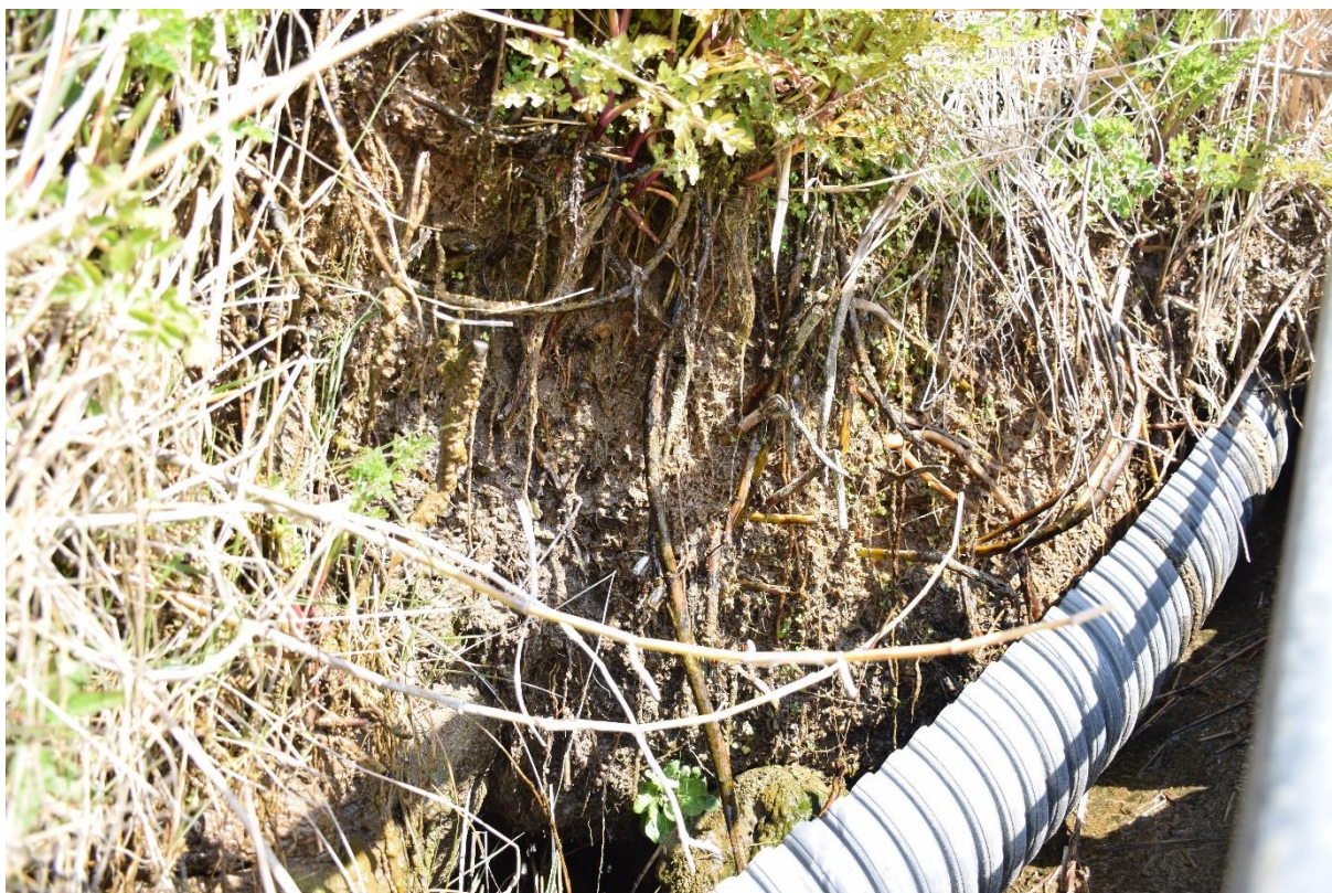
Illustration 40 : Zone de suintement/écoulement d'eau important au niveau de l'escalier à l'ouest de la plage
