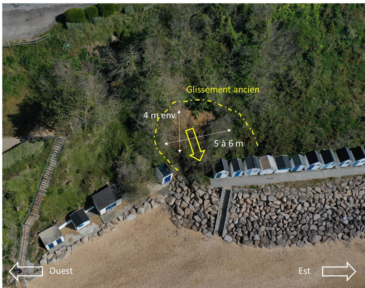
Illustration 37 : Photographie oblique du glissement de terrain ancien à l'arrière des cabines de plage (BRGM, Mai 2021)
