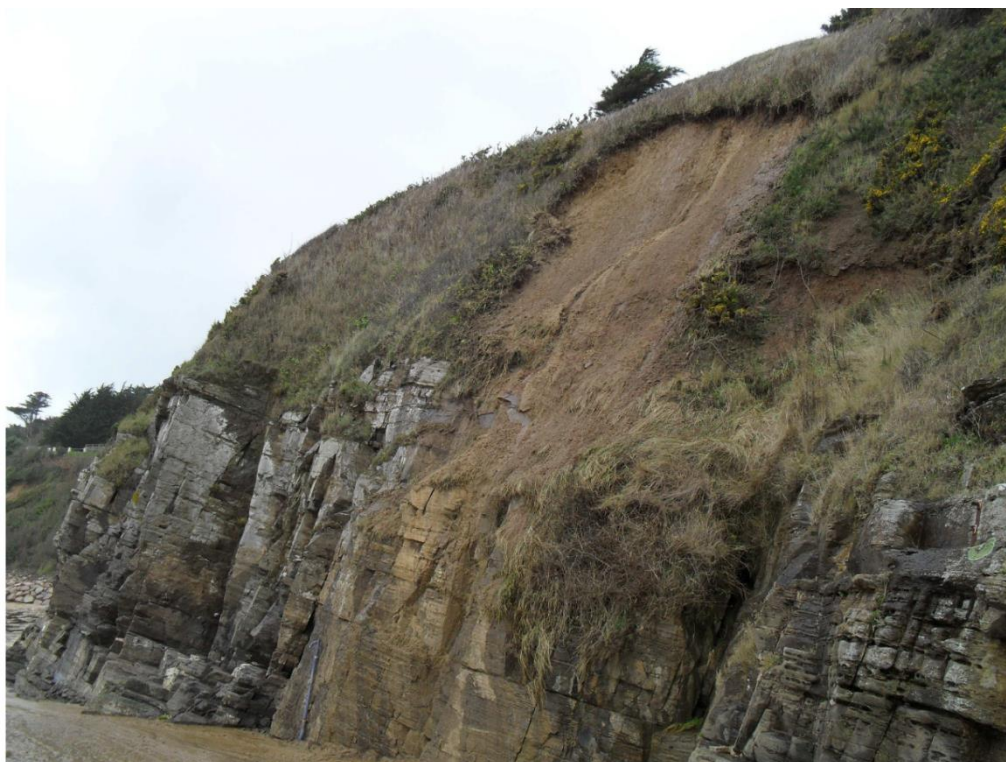
Illustration 16 : Glissement de formations superficielles en tête de paroi rocheuse au niveau de la descente d'accès plage (photo mairie 2012)
