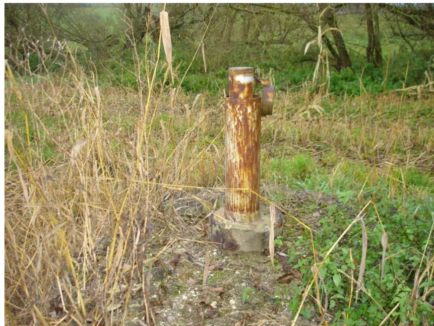
Figure 40 – Exemple de forage inaccessible (BSS000YQYV) actuellement obstrué par une sonde bloquée
