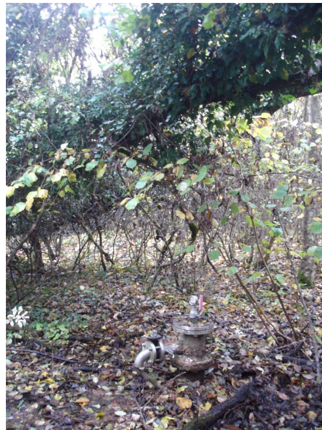
Figure 39 – Exemple de forage accessible (BSS000YRSQ) équipé d'un manomètre hors service mais avec risque (menace de chute de l'arbre situé juste au-dessus). Travaux de sécurisation à prévoir.
