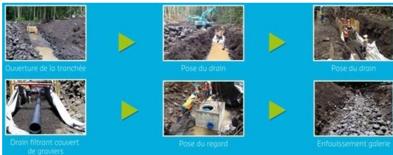
Illustration 17 - Étapes de réalisation de la galerie drainante de Nahoata haut (Pirae) en 2014 (source : ville de Pirae).
